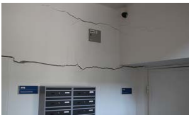
Fot. 2. Pęknięcia ściany podłużnej nośnej parteru budynku przechodzące na poprzeczną ścianę przydylatacyjną [2]
