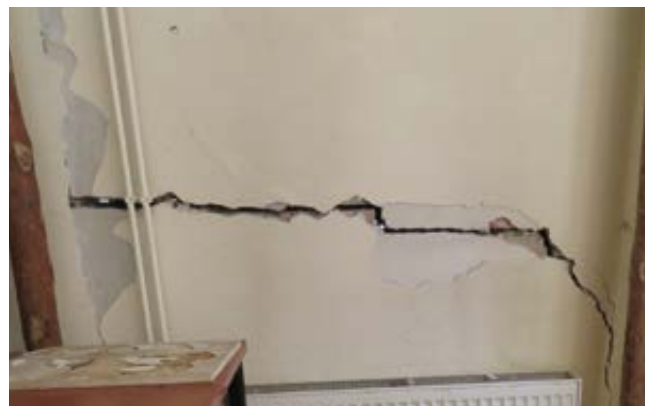
Fot. 5. Pęknięcia przydylatacyjnej ściany parteru budynku z oddzieleniem jej fragmentów [2]
