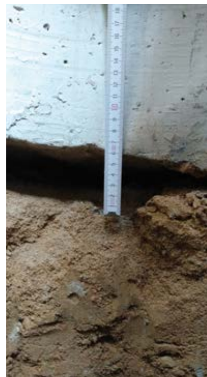
Fot. 6. Pustka pod posadzką podłogi pomieszczenia parteru budynku
