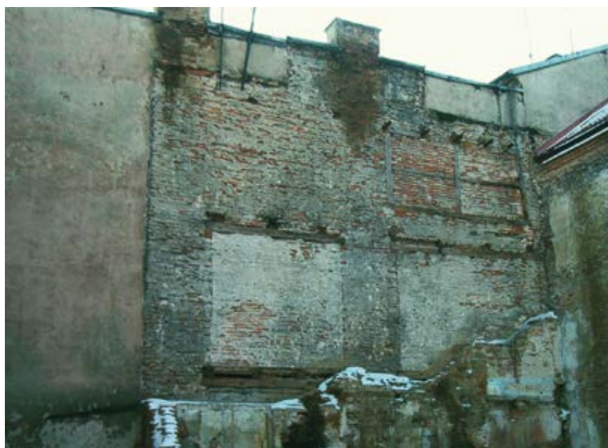
Fot. 1. Ściana budynku po rozbiórce obiektu przyległego
