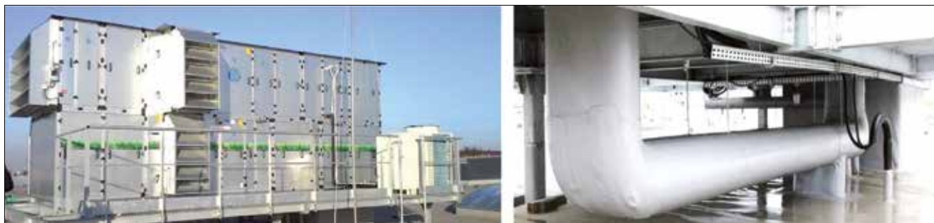
Fot. 2. Centrala FCH z dolnym podejściem mediów i kanały nawiew-wywiew
