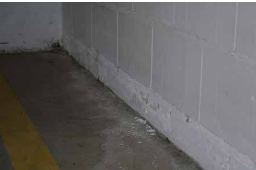
Fot. 5. Wykwyty wapienne na powierzchni zawilgoconych bloczków silikatowych
