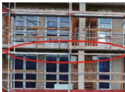
Fot. 4. Widok na balustradę – brak belek krawężnikowych na dwóch sąsiednich polach
