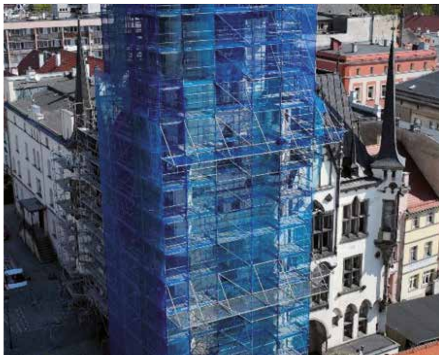
Fot. 1. Rusztowanie robocze z siatką i daszkami ochronnymi
