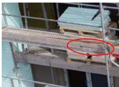
Fot. 5. Uszkodzona belka krawężnikowa
