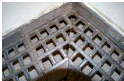
Fot. 3. Nieprawidłowy sposób połączenia fragmentów korytka odwodnienia liniowego w narożu
