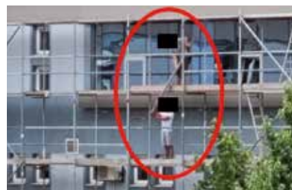
Fot. 6. Pracownicy montujący rusztowanie budowlane, nieposiadający odpowiednich środków ochrony indywidualnej
