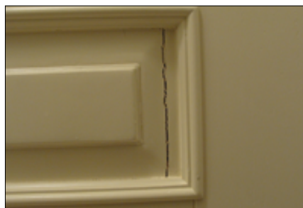
Fot. 6. Pęknięta płyta wypełnienia skrzydła drzwi, złożona ze sklejonych czołowo desek
