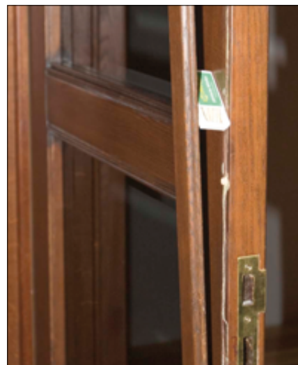
Fot. 9. Odpadające opaski drzwi, przyklejone do skrzydeł przy użyciu pianki poliuretanowej. Po pierwszym zatrzaśnięciu drzwi przez podmuch wiatru (przeciąg) opaska opadła i przez barierkę spadła do salonu poniżej
