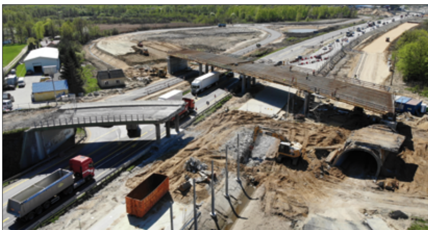
Fot. 13. Rozbiórka wiaduktu w Żabiej Woli z utrzymaniem ruchu po wschodniej jezdni, z tyłu WD-5
