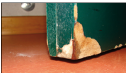
Fot. 13. Drzwi przeciwpożarowe po umyciu podłogi (mopem, bez zalewania posadzki). Skrzydło z płyty MDF spęczniało od wody, pozbawiono je uszczelek, gdyż blokowały zamknięcie drzwi
