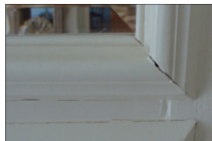
Fot. 3. Rozklejone listwy przyszybowe drzwi wewnętrznych i nierówno docięte końce. Drewno, z którego wyprodukowano listwy, było niedosuszone. Przy tak zawalonym kształcie powierzchni listew taka wada jest bardzo widoczna
