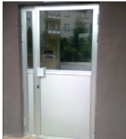
Fot. 17. Oryginalne drzwi wejściowe do klatki schodowej z 1991 r. ze zwykłą szybą float 4 mm (rodzaj szkła dopuszczony wtedy do takich zastosowań). W 2010 r. bawiące się w berka dziecko „przyklepało” szybę i pokaleczyło się (założono mu osiem szwów). Po tym wypadku szybę zamieniono na szybę bezpieczną. Dla bezpieczeństwa użytkowników wszystkie stare drzwi powinny być zmodernizowane, chociażby tylko przez wymianę szyb
