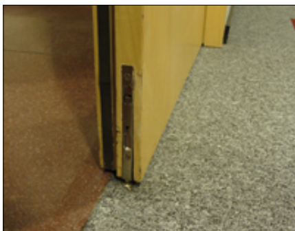
Fot. 10. Dwuskrzydłowe drzwi przeciwpożarowe z uszkodzonym tzw. kantrygiel, który ma zadanie blokowanie skrzydła biernego
