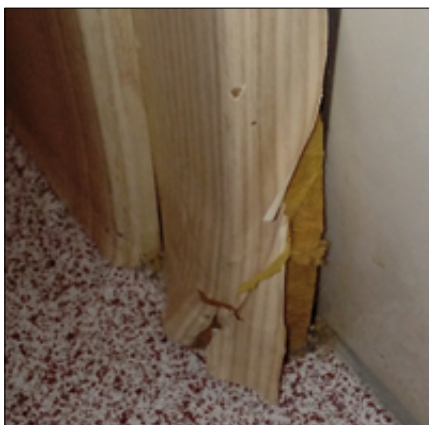
Fot. 12. Papierowy „fornir” oklejający ościeżnicę drzwi w pomieszczeniu sanitarnym – łazienka. Sama ościeżnica uformowana na płyty pilśniowej
