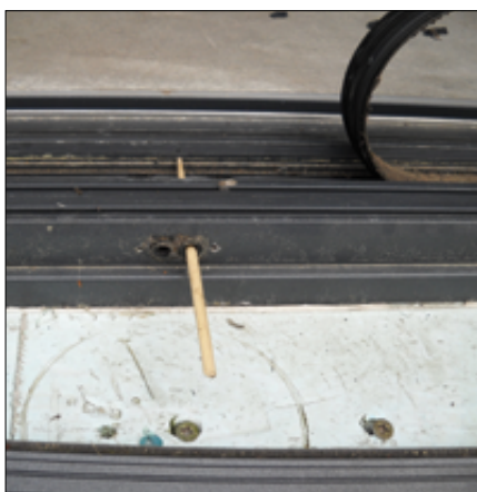
Fot. 21. Dolna prowadnica i próg drzwi przesuwnych. Z powodu przecieków wody opadowej do mieszkania pod posadzkę podłogi zastosowano nowatorskie rozwiązanie zalania gniazda prowadnicy płynnym lepikiem, następnie naklejono gumowe szerokie taśmy maskujące (by zakryć lepek). Odwodnienia pozostały pod naklejoną taśmą – wskazane patyczkiem wsuniętym w otwór odwodnienia
