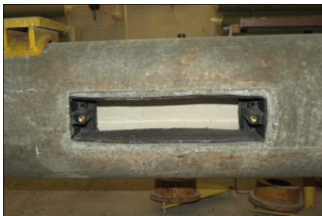
Fot. 3. Wnęki bezpiecznikowo-złączeniowa [7]
