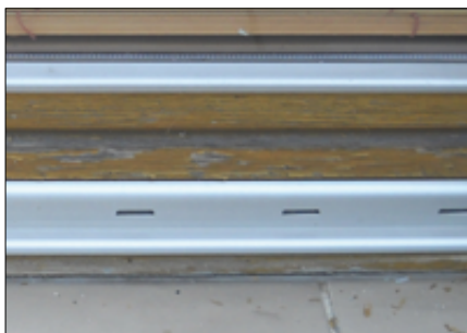
Fot. 4. Złuszczony lakier na dolnej ramie drzwi na taras balkonowy. Drzwi ustawiono bezpośrednio na płytkach tarasu – bez izolacji od zacieków wody
