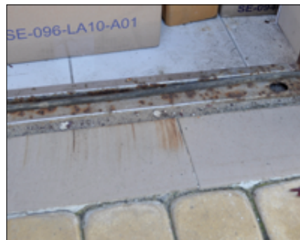
Fot. 18. Skorodowany próg aluminiowych drzwi wejściowych po pół roku ich użytkowania. Po prawej stronie widoczna w progu dziura, w którą wcieka woda opadowa do stropu budynku
