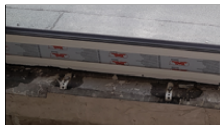
Fot. 22. Montaż ciężkich drzwi przesuwnych na kotwach z blachy, zastępujących klocki podporowe. Miejsca przecieków zaklejone lepikiem, woda z tarasu wcieka po ułożonej izolacji
