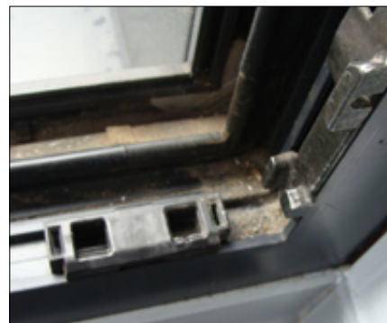
Fot. 23. Nieprzykręcony przesunięty dolny zaczep okucia skrzydła rozwierno-uchylnego w drzwiach w hotelu; kantrygiel okucia nie wchodził w otwór zaczepu. Gość hotelu chciał w nocy otworzyć uchylone skrzydło, pociągnął za klamkę i „wyszedł” z pierwszego piętra na trawnik. Obiekt nie ma balustrad (taki był projekt)
