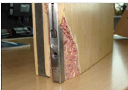
Fot. 11. Te same drzwi przeciwpożarowe – szarpnięty przeciągiem powietrza kantrygiel wyrwał fragment okładziny
