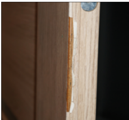
Fot. 15. Przytarta i rozerwana okleina skrzydła drzwi przez źle zamontowaną do ściany wykrzywioną ramę ościeżnicy. Montażysta nie uznał reklamacji
