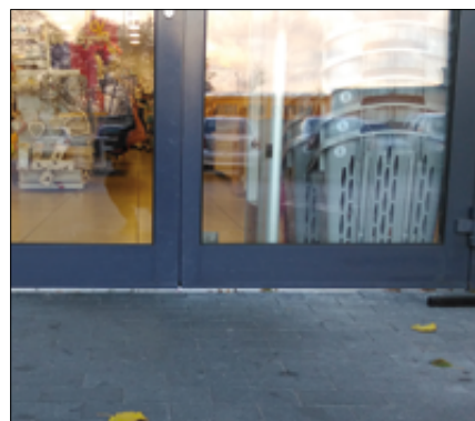
Fot. 19. Drzwi wejściowe do pawilonu handlowego. Montażysta „zapomniał” o progu drzwi – w efekcie z posadzki chodnika woda splywa do sklepu na drewnianą posadzkę, szczelina jest tak duża, że wzwiewa do środka liście i śmieci
