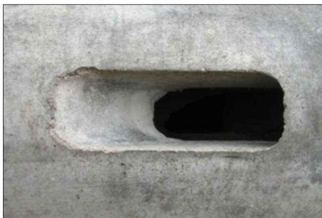
Fot. 4. Szczelina wlotowa kabli [7]
