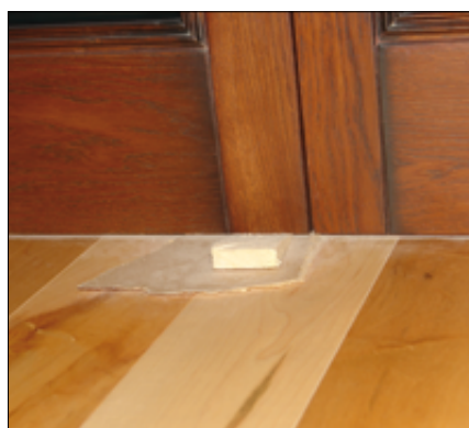
Fot. 7. Luksusowe dwuskrzydłowe harmonijkowe drzwi (skrzydła dwuczęściowe), szerokości skrzydeł po 140 mm, oszklone szybami z krzysztalu grubości 8 mm. Skrzydła są tak ciężkie, że nawet poczwórne zawiasy nie mogą ich utrzymać i drzwi „szorują” po posadzce
