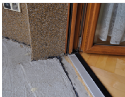
Fot. 8. Próg drzwi wpuszczony w posadzkę tarasu – woda pod listwą progu przecieka do mieszkania
