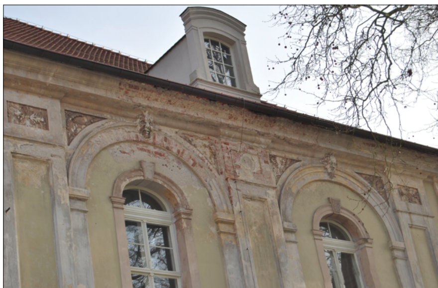
Fot. 6. Niszcząca elewacja wschodnia
