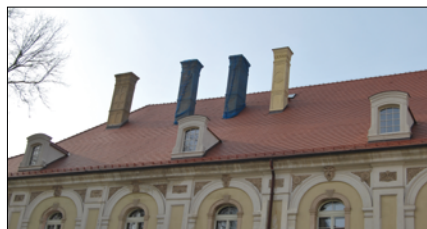
Fot. 5. Stan techniczny pozostawionych bez remontu kominów w 2015 r.
