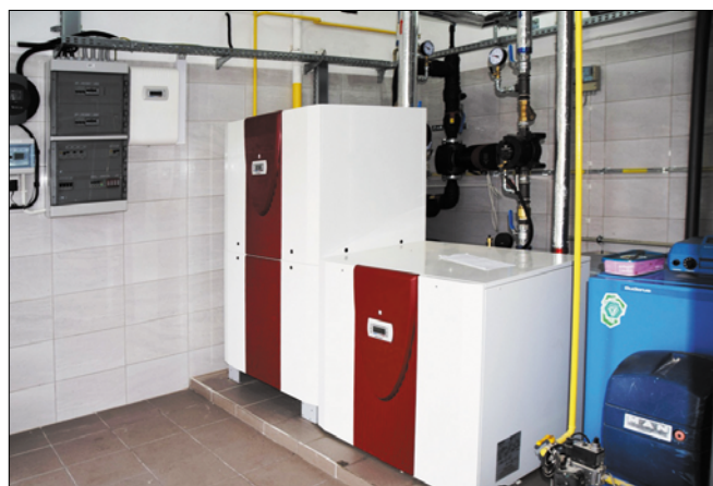
Fot. 7. Pompa ciepła solanka/woda (szkoła w Warszawie)
