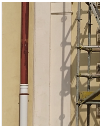
Fot. 11. Połączenie rury spustowej plastikowej z metalową (mieszanie materiałów)
