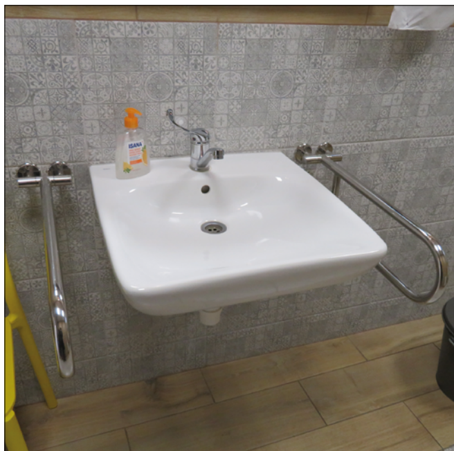
Fot. 3. Umywalka dla osób niepełnosprawnych
