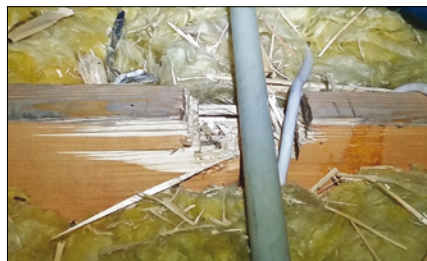
Fot. 4. Uszkodzony przez montażystów instalacji pas dolny wiązara (fot. T. Nowak)
