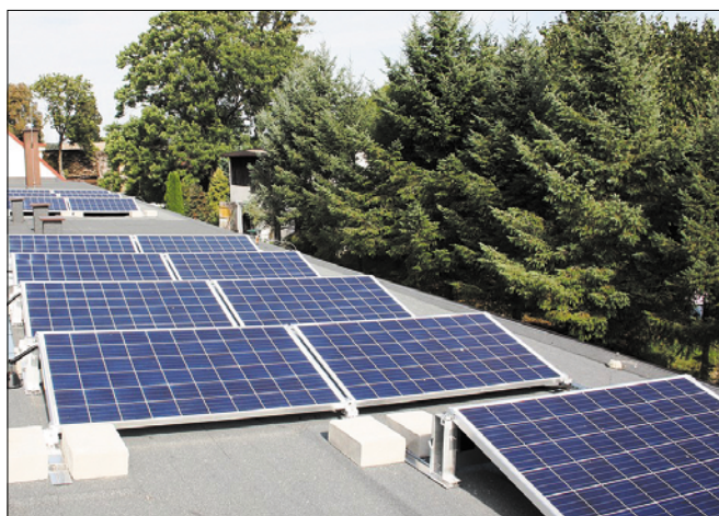
Fot. 5. Instalacja fotowoltaiczna na dachu przedszkola w Gniazdowie
