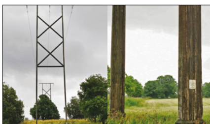
Fot. 3. Słupy trakcji elektrycznej Szwecja (fot. S.-E. Johansson)
