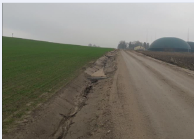
Fot. 2. Uszkodzenia dna rowu przez opady
