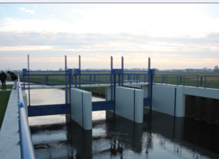
Fot. 3. Jaz na rzece wyposażony jest w trzy komplety zasuw stalowych dwudzielnych z ręcznymi mechanizmami wyciągowymi (fot. B. Klem)
