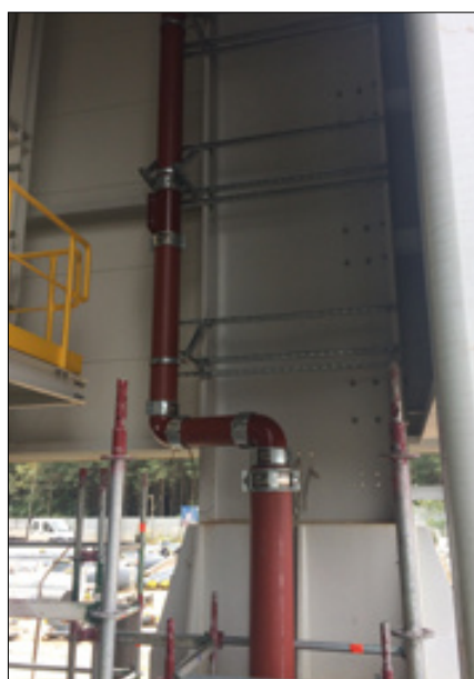
Systemy EPAMS® i SMU® zastosowano w nowym bloku energetycznym Elektrowni Jaworzno
