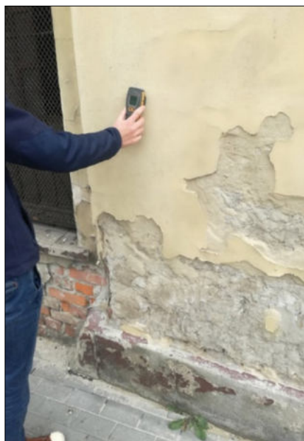
Fot. 4. Degradacja muru spowodowana podciąganiem kapilarnym
