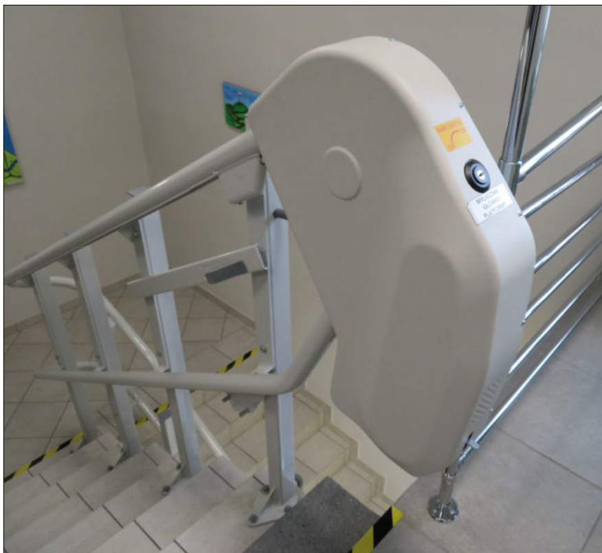
Fot. 3. Platforma schodowa
