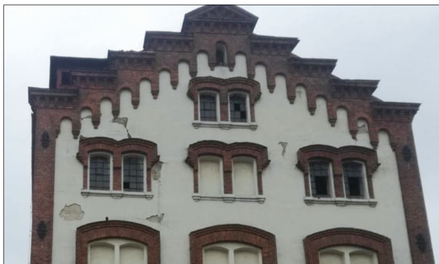
Fot. 5. Elewacja kamienicy będącej dominantą zespołu manufaktury Grossa. Widoczny objaw higroskopijnego poboru wilgoci z powietrza oraz wód opadowych
