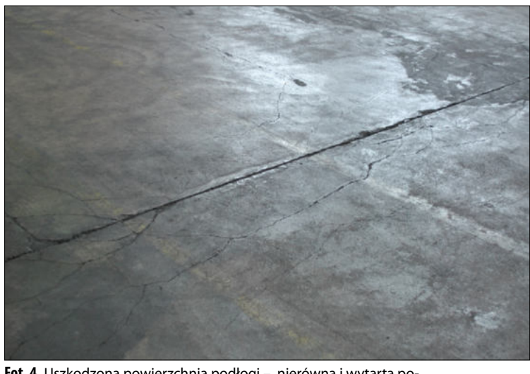
Fot. 4. Uszkodzona powierzchnia podłogi – nierówna i wytarta powierzchnia posadzki/zasyпки
