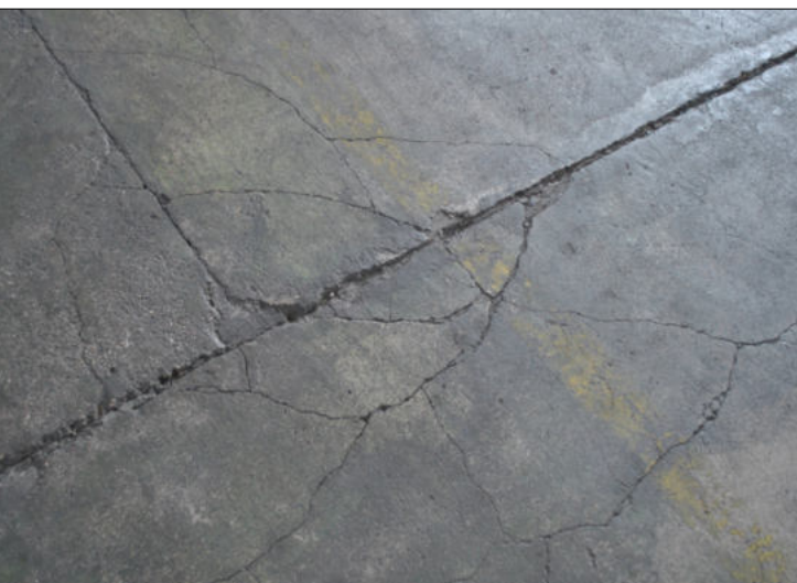
Fot. 3. Posadzka w narożnikach płyt – nieprawidłowa lokalizacja dylatacji
