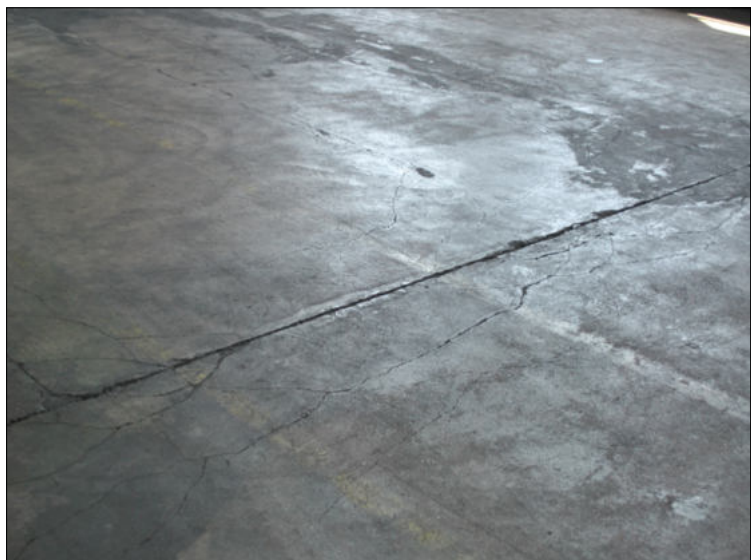
Fot. 2. Uszkodzona podłoga – przeciężona płyta podłogi
