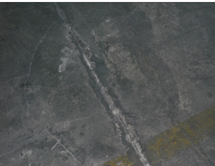
Fot. 1. Uszkodzona dylatacja – przeciężona płyta podłogi
