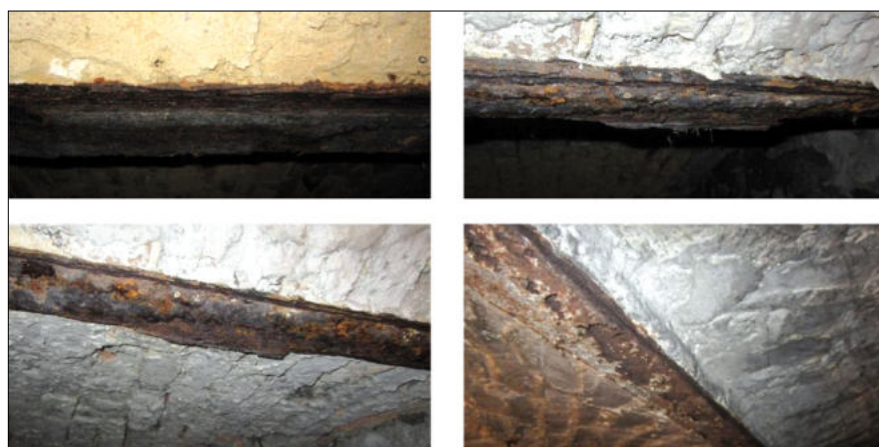
Fot. 1. Przykłady uszkodzeń korozyjnych belek stropów odcinkowych
