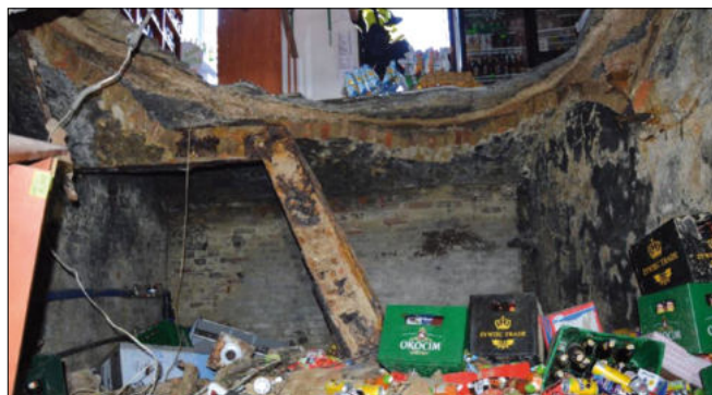
Fot. 3. Całkowicie zawalone sklepienie
