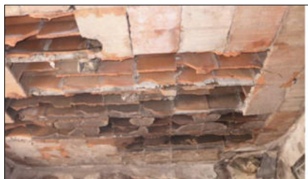
Fot. 9. Uszkodzenia pożarowe stropu Ackermana
