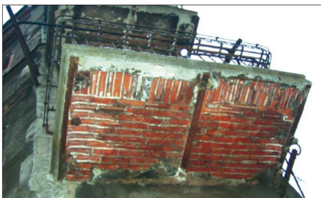
Fot. 5. Zły stan techniczny balkonu (styczeń 2006 r.) – widoczne rozmrożenia cegieł dziurawek do poziomu pierwszego rzędu otworów, zły stan belek stalowych
