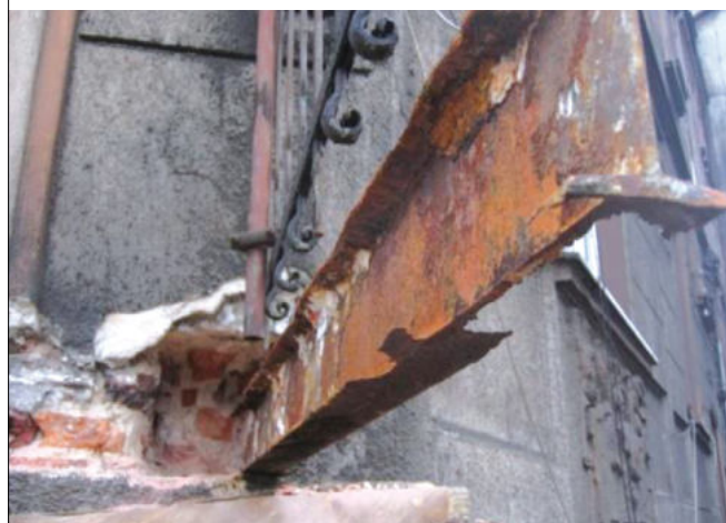
Fot. 6. Katastrofa budowlana balkonu (marzec 2009 r.)
