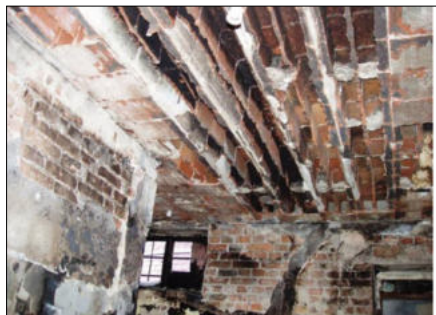
Fot. 8. Uszkodzenia pożarowe stropu Ackermana (fot. R. Jasiński)
