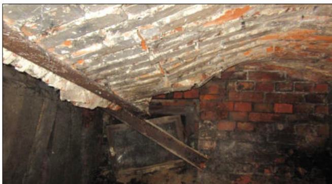
Fot. 2. Częściowo zawalone sklepienie
