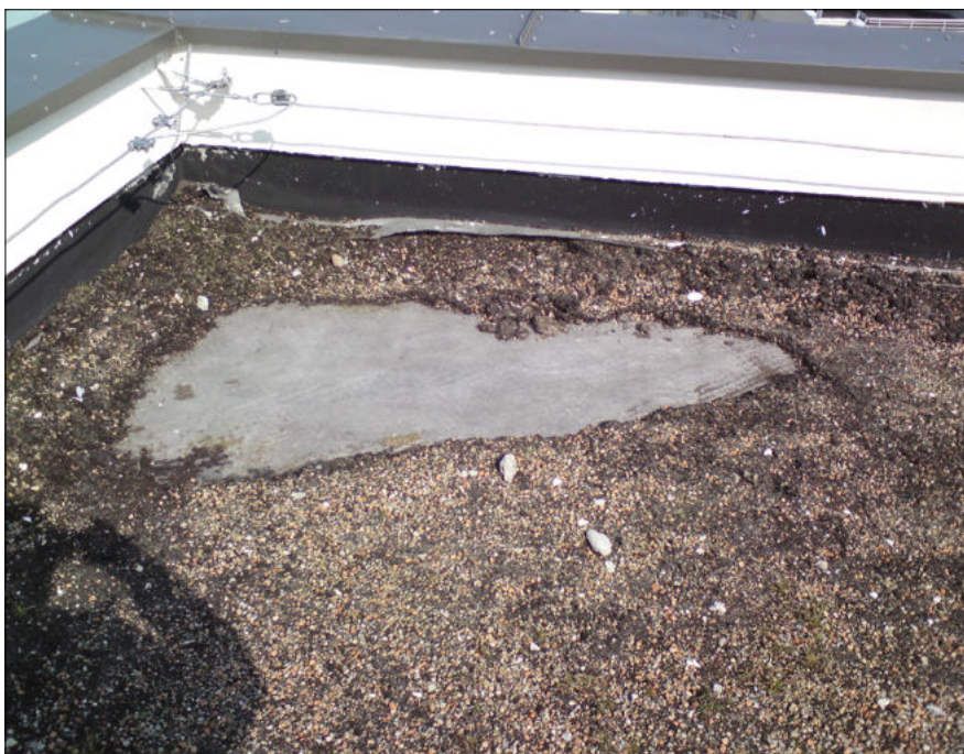
Fot. 3. Brak opaski żwirowej powoduje wywiewanie substratu
