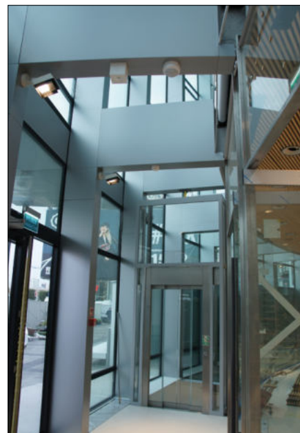
Fot. 3. W przestrzeni między ścianami kurtynowymi umieszczono dźwigi (windy)
