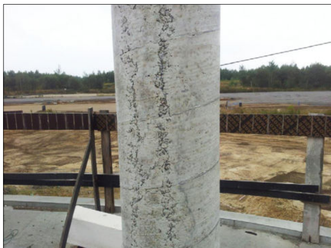
Fot. 1. Efekt złe dobranych domieszek (fot. autora)
