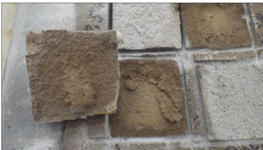
Fot. 2. Przyczepność kleju cementowego do betonu
