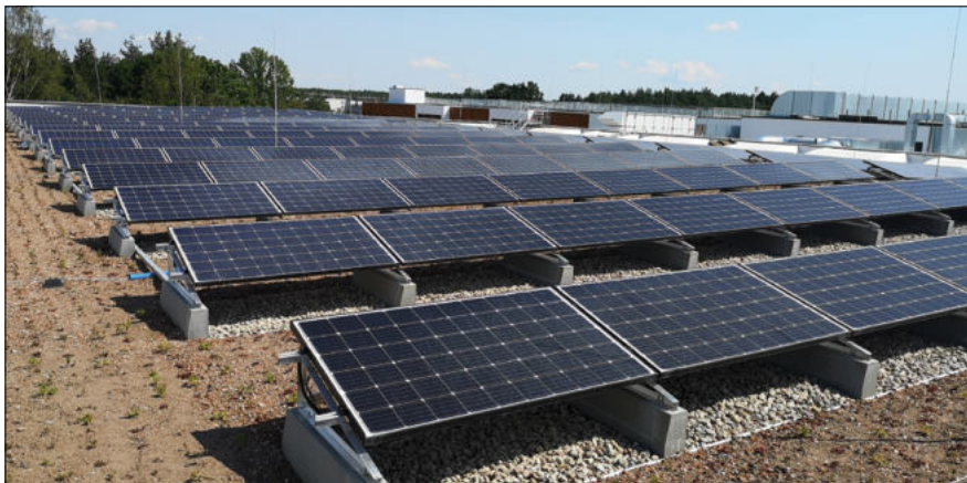
Fot. 2. Urządzenia solarne na dachu zielonym balastowym
