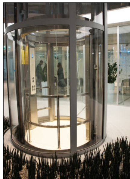
Fot. 6. Kabina okrągła na poziomie -1
