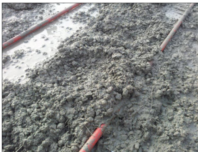
Fot. 2. Segregacja mieszanki na skutek złe dobranych domieszek (fot. autora)
