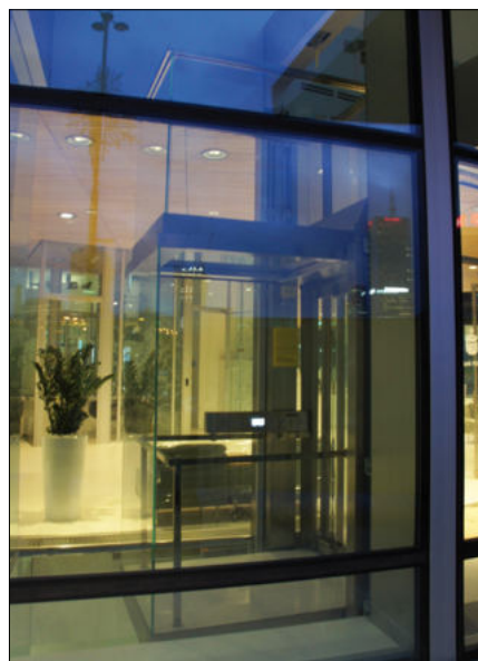
Fot. 4. Kabina dźwigu W1 na przystanku
