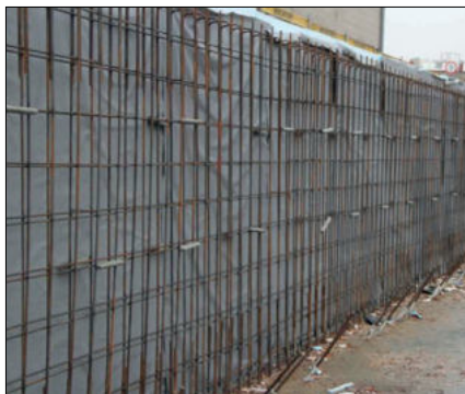
Fot. 4. Ścianka berlińska przy granicy działki z przygotowaną do betonowania izolacją krystalizującą w formie rolowej
