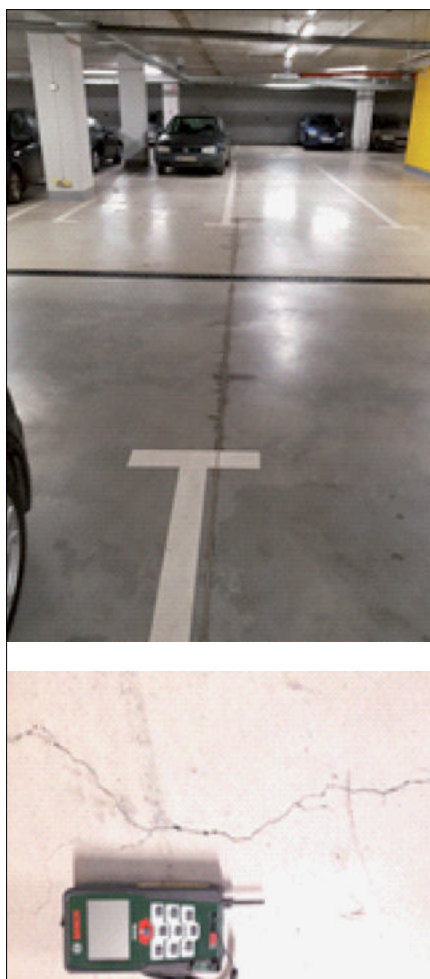
Fot. 1. Zarysowania płyty parkingowej o szerokości rys powyżej 0,6 mm
