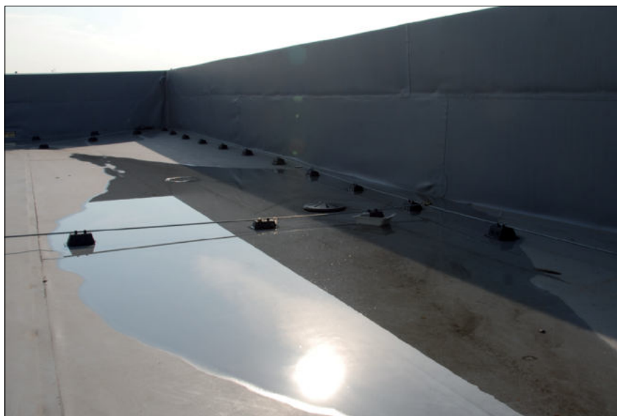
Fot. 2. Zastój wody opadowej przy odpływie ciśnieniowym
