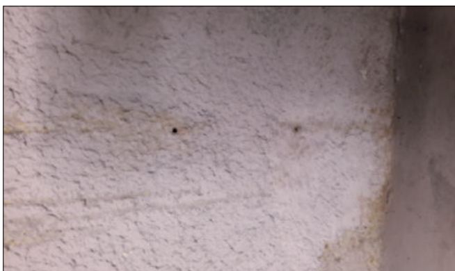
Fot. 2. Zawilgocenia przy połączeniu ściany szczelinowej z płytą fundamentową
