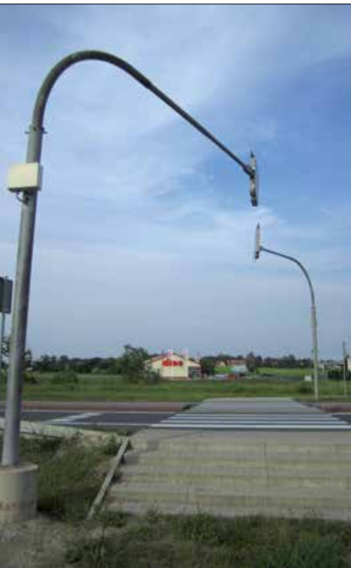
Fot. 2 | Niewłaściwe umieszczenie opraw oświetlających przejście dla pieszych
