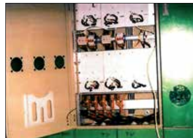
Fot. 3 | Rozdzielnica licznikowa, rozprawa-dzenie wiązek przewodów od wyłącznika głównego do szyn rozgałęznych i od nich do tablic licznikowych
