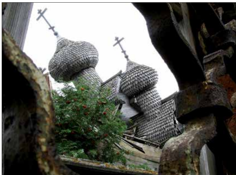
Fot. 2 | Wyrócenie kopuły cebulkowej z powodu utraty nośności podtrzymujących ją elementów konstrukcyjnych
