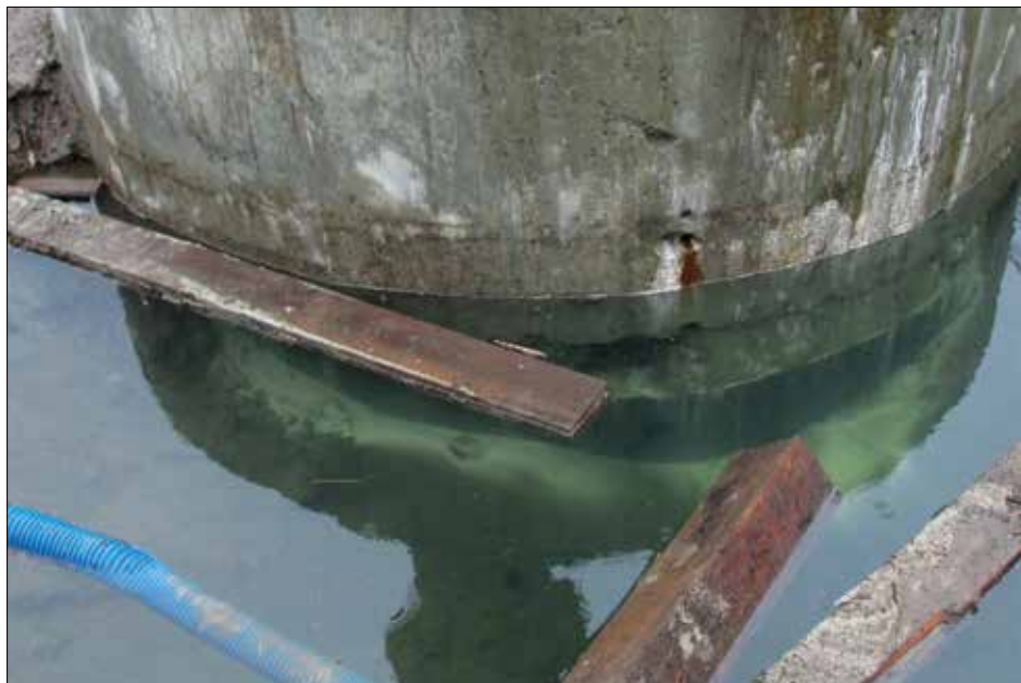
Fot. 1 | Pobocznicza pala z widocznymi śladami wypływu wody
