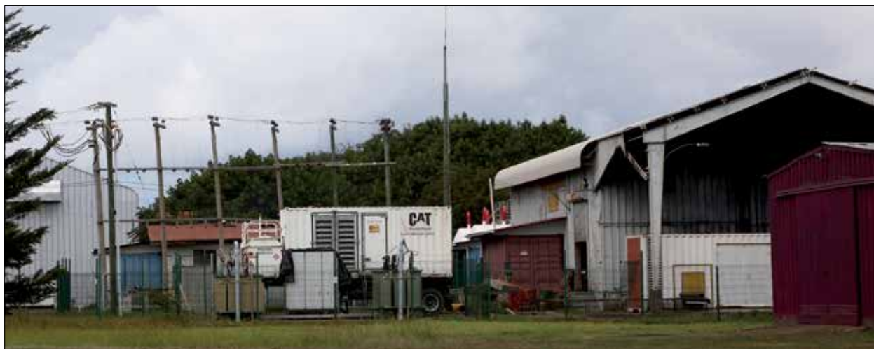
Wyspa Wielkanocna – elektrownia olejowa
