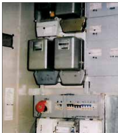
Fot. 4 | Rozdzielnica licznikowa niezgodna z normami i przepisami, wyłącznik główny i wyłączniki administracyjne razem z licznikami
