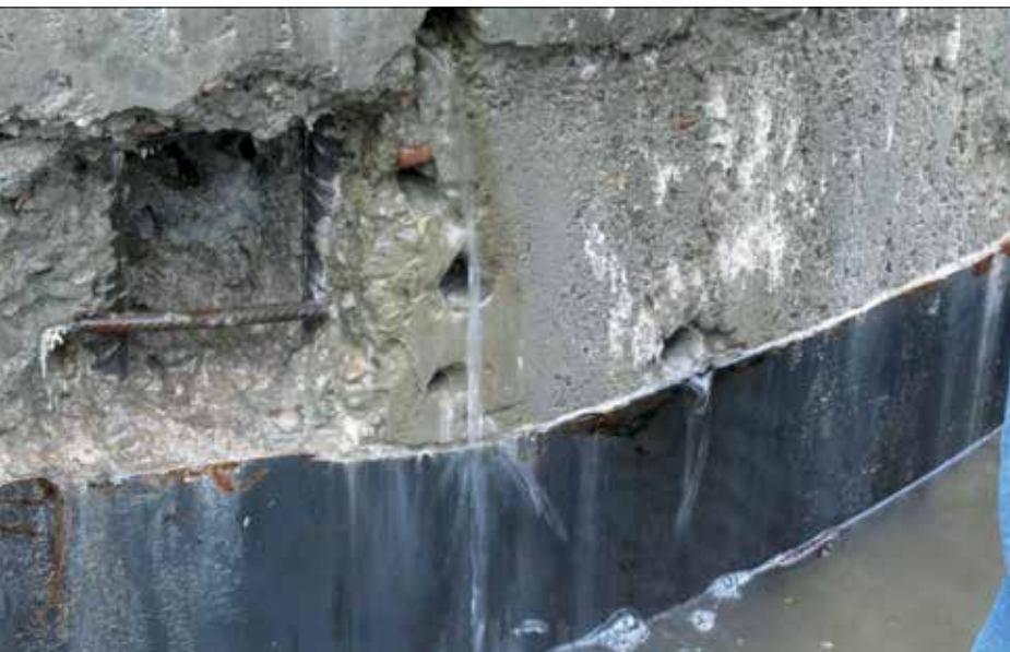
Fot. 2 | Wypływ wody z wnętrza pali przez nawiercone otwory
