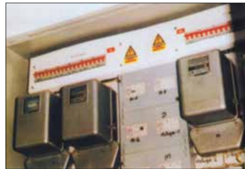
Fot. 5 | Rozdzielnica licznikowa, wyposażenie niezgodne z normami i przepisami – rozłączniki i listwy zaciskowe przewodów N i PE ogólnie dostępne
