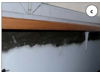
Fot. 3b, c Skutek błędów w wymianie okien i dociepleniu budynku. Wyraźnie widoczne grzyby pleśniowe na uszczelce i ościeżnicy okna z PVC. W narożniku szyby można zauważyć skropliny wilgoci umożliwiające rozwój grzybów pleśni. Pod parapetem ciemny pas będący koloniami zarodników (ściana wyszpachlowana gładzią gipsową)
