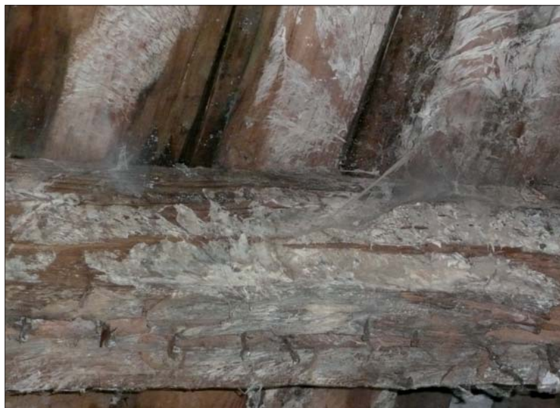
Fot. 5 | Krokiew i deskowanie połaci zaatakowane przez grzyba domowego właściwego ( Serpula lacrymans )
