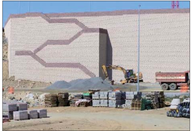
Fot. 3 | Ściana oporowa z licem z bloczków, system Rockwood, Hiszpania, 2002 (fot. Huesker)
