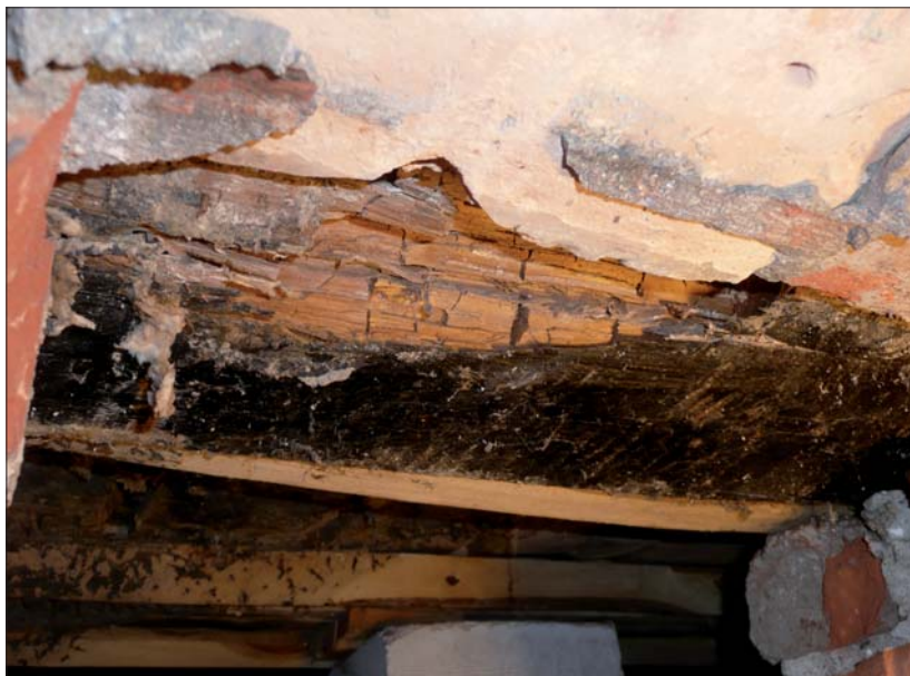
Fot. 4 Podłoga na gruncie – widok od spodu. Pryzmatyczne spękania belki (tzw. rozkład brunatny) świadczą o zaawansowanych procesach destrukcyjnych
