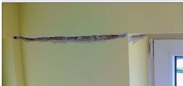
Fot. 1 | Zarysowanie w miejscu dolnej krawędzi belki po lokalnym usunięciu zarysowanego tynku
