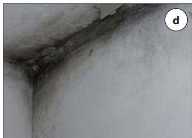
Fot. 3d Grzyby pleśniowe w miejscu występowania mostka termicznego
