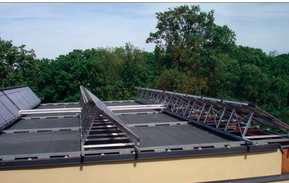
Fot. | Baterie paneli słonecznych na dachu budynku, przy których mogą się tworzyć zaspasy śnieżne
