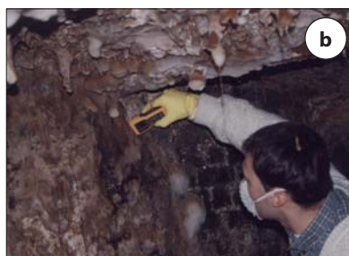
Fot. 6b | Piwnica w budynku murowanym, strop nad piwnicą drewniany. Bardzo zaawansowane stadium rozwoju grzyba
