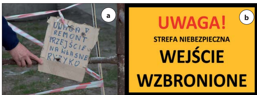
Fot. 1 | Nieprawidłowe (a) i prawidłowe (b) oznakowanie prac rusztowaniowych
