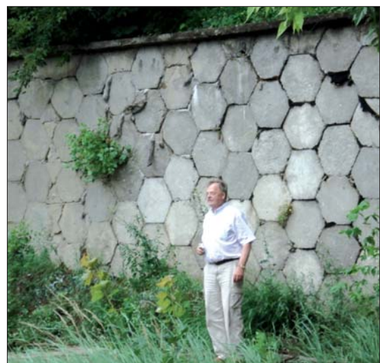
Fot. 1 Jedna z pierwszych ścian oporowych z gruntu zbrojonego w Polsce (rok budowy 1980), teren byłej kotłowni, Osiedle Strzelecka, Chelmino, stan 2012 (fot. J. Sobolewski)
