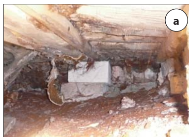
Fot. 6a | Podłoga na gruncie (widok od spodu) zaatakowana przez grzyba domowego właściwego ( Serpula lacrymans ). Wyraźnie widoczny zwisający z belki wykształcony owocnik. Bordowe zabarwienie jest skutkiem rozsiewania zarodników
