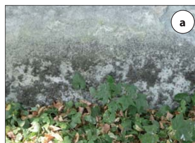
Fot. 3a Grzyby pleśniowe rozwijające się na powierzchni muru w strefie cokołowej
