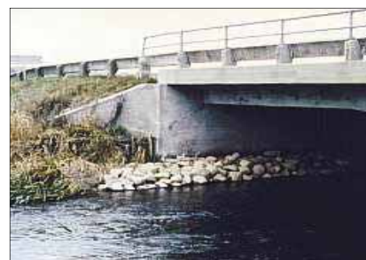
Fot. 5. Przejście dla zwierząt w formie przepustu o charakterze mieszanym (ciek wodny pod korpusem drogi) zbudowane z głazów [8]
