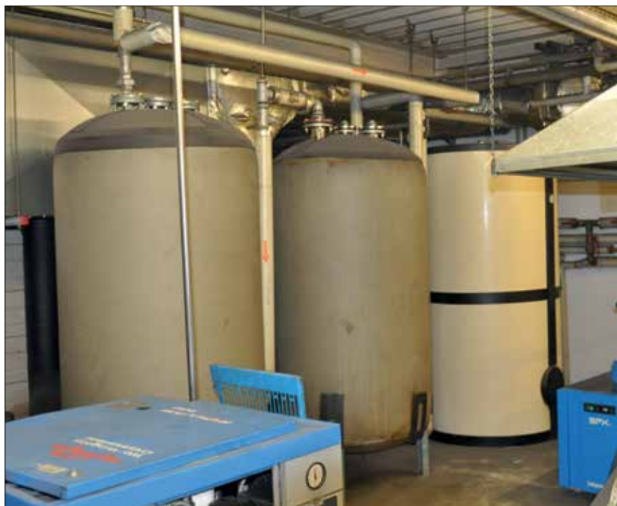
Fot. 2. Akumulacja ciepłej wody w trzech zbiornikach w hali zatrudniającej 230 osób do pracy brudzącej na trzy zmiany
