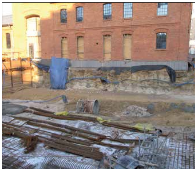
Fot. 1. Budynek rewitalizowanej zabytkowej fabryki posadowiony w czasie przebudowy na kolumnach jet grouting
