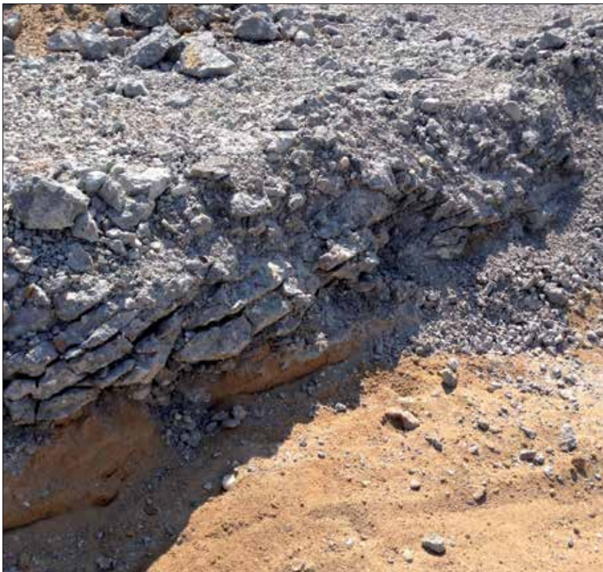
Fot. 3. Przekruszony fragment nawierzchni (fot. archiwum firmy Rekma)
