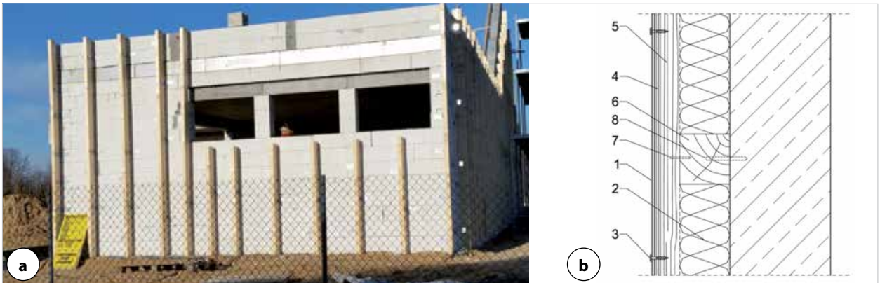
Rys. 4 | Podkonstrukcja drewniana: a) przykład realizacji, b) schematyczny przekrój elewacji: 1) okładzina elewacyjna, 2) wełna mineralna z welonem szklanym, 3) łącznik płyty, 4) taśma EPDM, 5) łąta drewniana, 6) rygiel drewniany, 7) łącznik do elementów drewnianych, 8) kotwa mocująca do ściany
