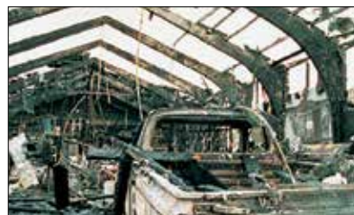
Fot. 4 | Dźwigary z drewna klejonego utrzymujące swój profil jeszcze po pożarze
