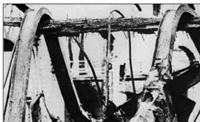
Fot. 3 | Zdjęcie obiektu po pożarze, widoczne uplastycznione elementy stalowe wiszące nad nadal przenoszącymi obciążenia elementami drewnianymi
