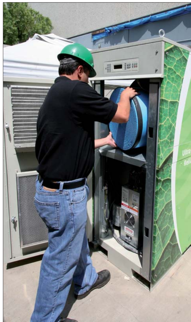
Fot. 2 | Mikroturbina w papierni
