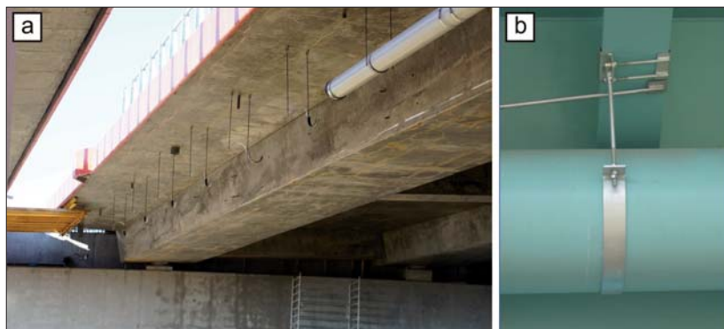
Fot. 5 | Sposób podwieszenia kolektorów odwodnienia do spodu konstrukcji mostu za pomocą odpowiednich zawiesi: a) zawieszanie w trakcie montażu do konstrukcji betonowej, b) widok wykonanego podwieszenia do konstrukcji stalowej
