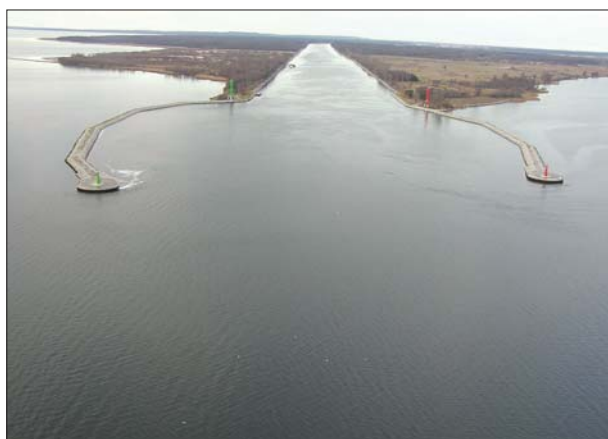
Fot. 5 | Umocnienia brzegowe Kanału Piastowskiego przed remontem (fot. UMS)
