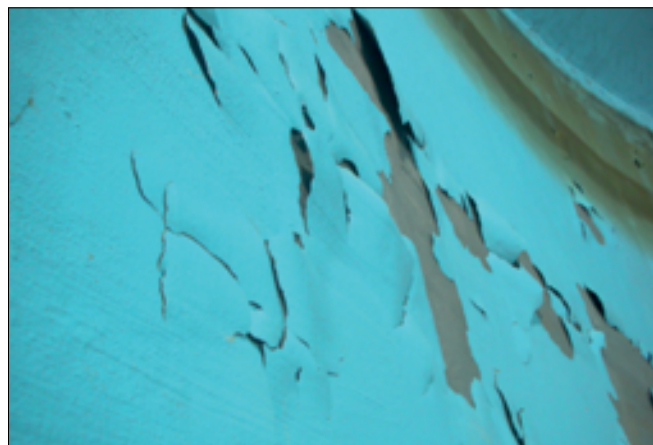
Fot. 2. Delaminacja żywicznej powłoki ochronnej nałożonej na wilgotny beton
