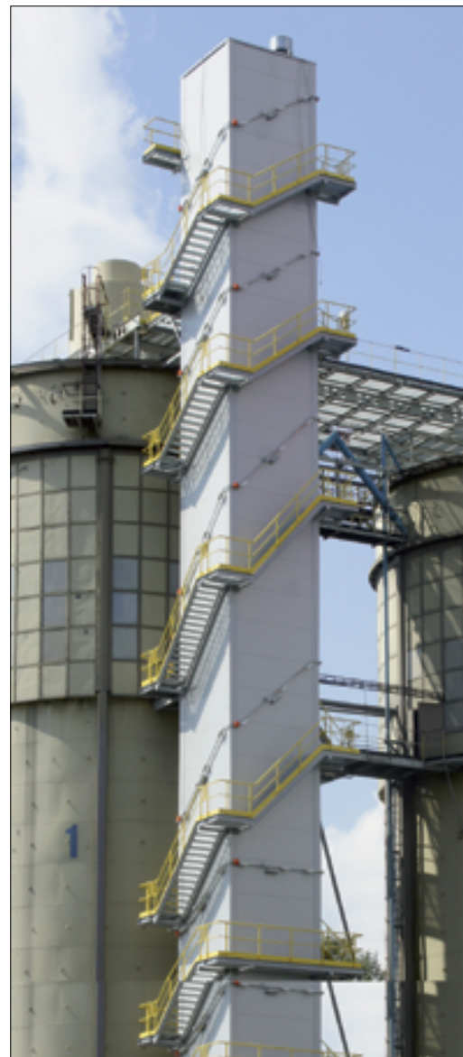
Fot. 10. Gotowy dźwig – wysokość szybu z maszynownią 48,25 m
