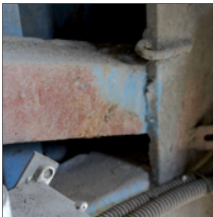
Fot. 2. Korozja konstrukcji starego szybu
