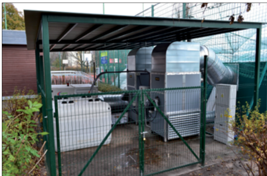
Fot. 6. Układ grzewczo-nadmuchowy – hala Syrenka, Warszawa
