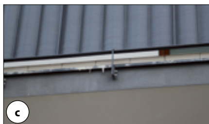
Fot. 5. Skutki nieszczelności w strefie okapu
