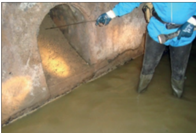
Fot. 1. Środowisko w konstrukcji, która była używana do gromadzenia wody, bezpośrednio przed renowacją jest zawsze bardzo wilgotne
