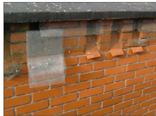
Fot. 3 | Błędnie wykonane zabezpieczenie wylotów kominu wentylacyjnego
