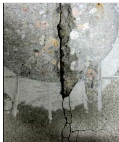
Fot. 6 | Pęknięta nawierzchnia oraz nadbeton
