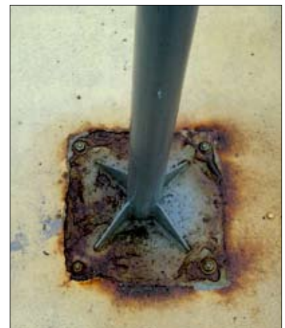
Fot. 2 Nieprawidłowo osadzona w płycie betonowej stopa znaku drogowego
