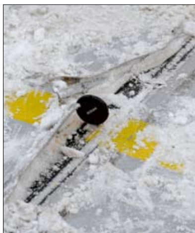
Fot. 4 | Uszkodzony profil urządzenia dylatacyjnego
