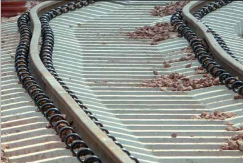
Fot. 3 | Wyboczenie toru pod wpływem obciążenia termicznego
