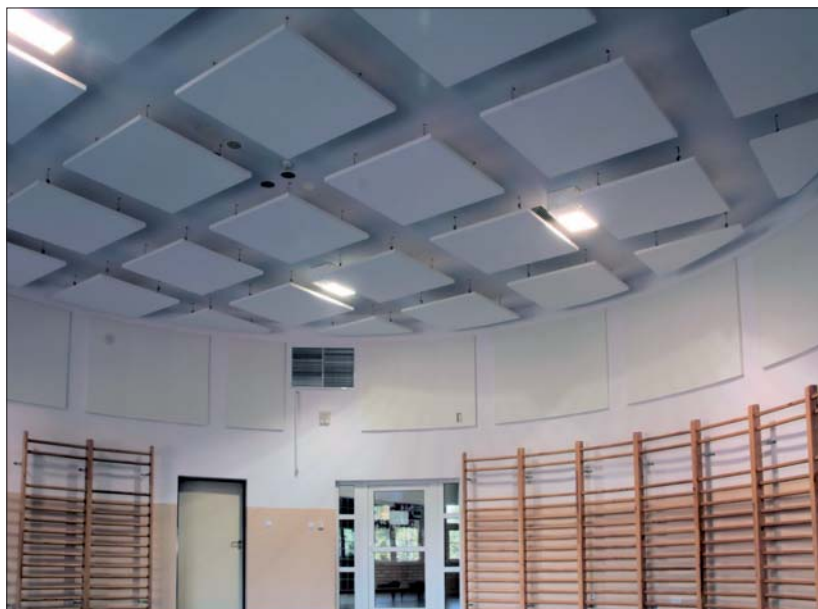
Fot. 3 Mała sala do gimnastyki korekcyjnej i zajęć tanecznych. Chłonność akustyczna zapewniona dzięki wolno wiszącym panelom z wełny szklanej oraz panelom ściennym (powyżej drabinek). Panele ścienne dodatkowo osłabiają niekorzystny efekt ogniskowania dźwięku przez półokrągłą ścianę
