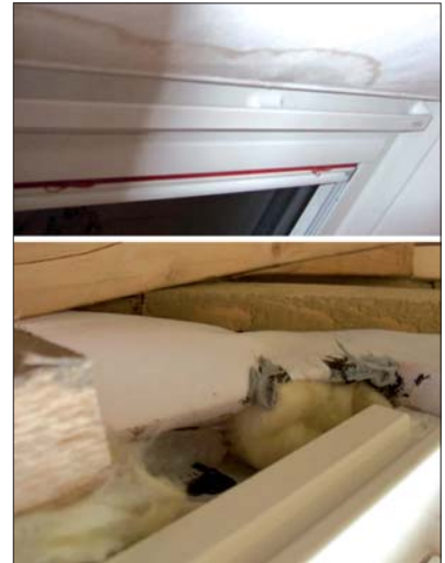
Fot. 4 Skutki braku ciągłości paroizolacji w pobliżu okna
