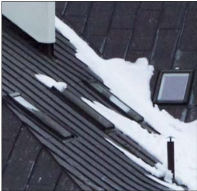
Fot. 2 Okna zamontowano w pobliżu kosza, zastoje lodu i śniegu mogą doprowadzić do przeciekania okien
