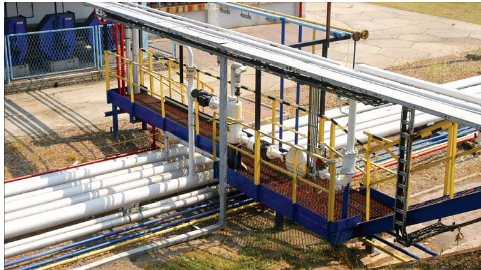
Fot. | Terminal przeładunkowy w Sosnowcu, Archiwum GAZ-SYSTEM S.A.
