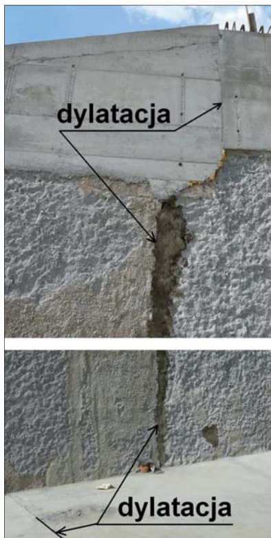
Fot. 2 | Ściana szczelinowa ze wzajemnie przesuniętymi dylatacjami wieńca, ściany i płyty dennej
