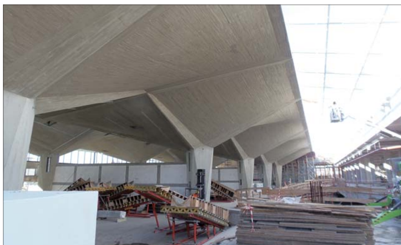
Fot. 1 | Wielkoformatowa przestrzeń handlowa powstająca pod „kielichami” nad dworcem PKP w Katowicach
