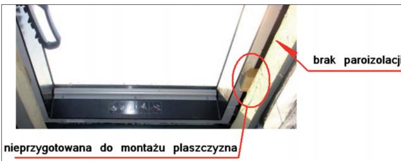
Fot. 3 | Nieprofesjonalne osadzenie okna – błąd montażowe
