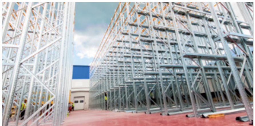
Fot. 1. Chłodnia w zakładzie Twardzik Chłodnia Owoców i Warzyw w Łaziskach k/Opola Lubelskiego w czasie konstrukcji
