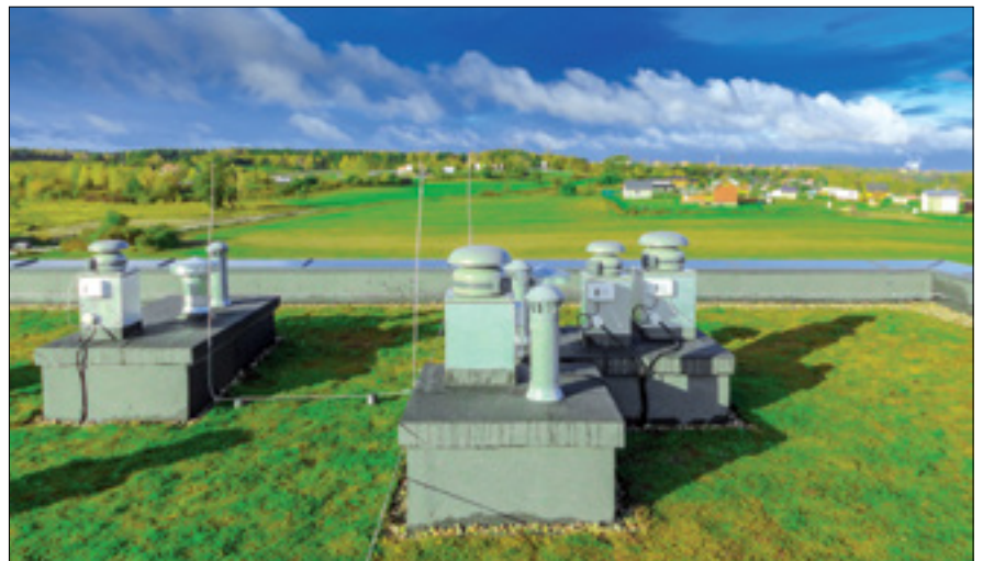
Fot. 1. Instalacja wentylacji mechanicznej na dachu zielonym komponującym się z otoczeniem
