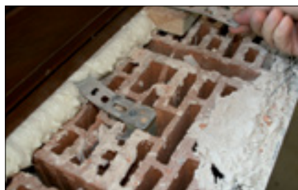
Fot. 10. Drzewi tarasowe ustawione wprost na cegle dziurawce, kotwy z blachy zamiast wsporników, klocek drewniany zamiast podparcia stabilnego
