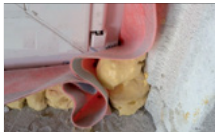
Fot. 16. Wada montażu warstwowego z użyciem taśm paroszczelnych
