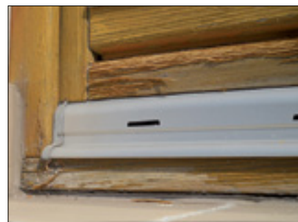
Fot. 9. Drzwi tarasowe ustawione wprost na posadzce, bez izolacji
