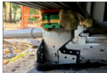
Fot. 8. Zagrażające stabilnością podparcie drzwi na wsporniku z „dodatkiem” podkładek szklarskich sklejonych pianką PU
