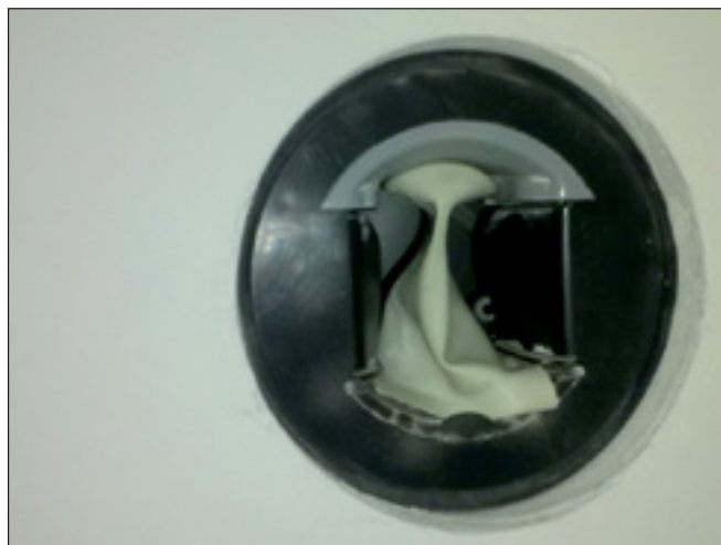
Fot. 3. Montaż regulatora przepływu powietrza z wysuniętą z gniazda membraną, uniemożliwiający późniejszą regulację wydajności
