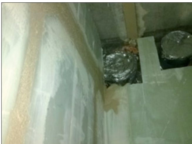
Fot. 4. Montaż króćca instalacji wentylacji mechanicznej wywiewnej w mieszkaniu zlokalizowany za blisko ścianki działowej, co uniemożliwi na późniejszym etapie zamontowanie kratki regulacyjnej
