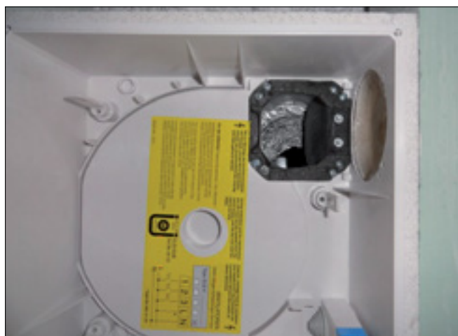
Fot. 7. Kłapa zwrotna w obudowie wentylatora podtynkowego, zamontowana w niewłaściwej pozycji uniemożliwiającej zamknięcie pod wpływem własnego ciężaru
