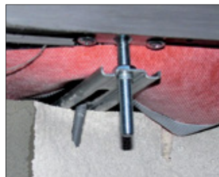
Fot. 11. Wada zamontowania okna na konsoli – niewłaściwy wkręt osadzony za blisko krawędzi muru
