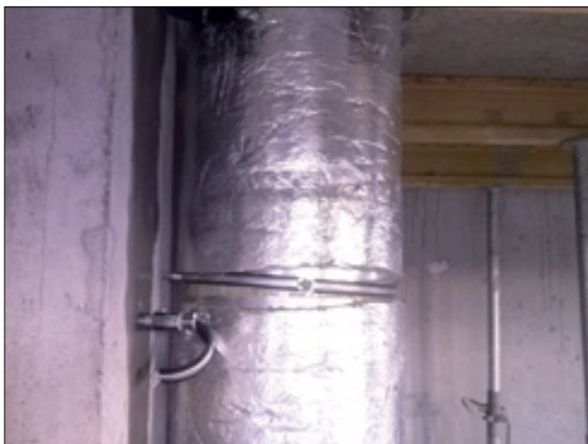
Fot. 2. Montaż pionu na obejmę z prętem gwintowanym niedostosowanym do ciężaru mocowanych elementów
