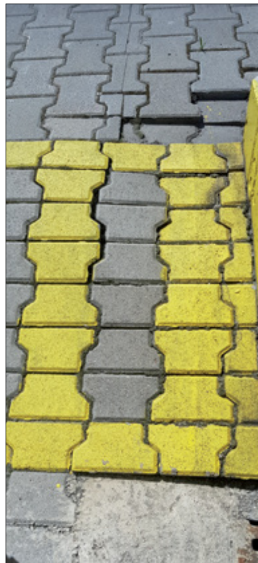
Fot. 3. Efekt zastosowania niewłaściwego materiału zasyпки
