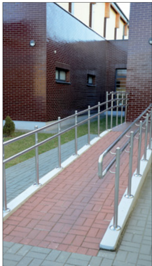
Fot. 1. Podjazd dla niepełnosprawnych z betonowej kostki brukowej (Pio Si – fotolia.com)
