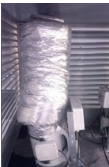
Fot. 6 Niewłaściwie zamontowany wentylator oraz wyrzutnia powietrza wyprowadzona bezpośrednio w osłonę kominą
