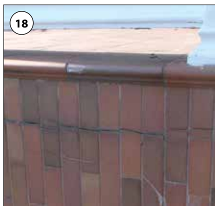
Fot. 17–18. Uszkodzenia związane z nieprzeanalizowaniem pracy konstrukcji biegu i spocznika
