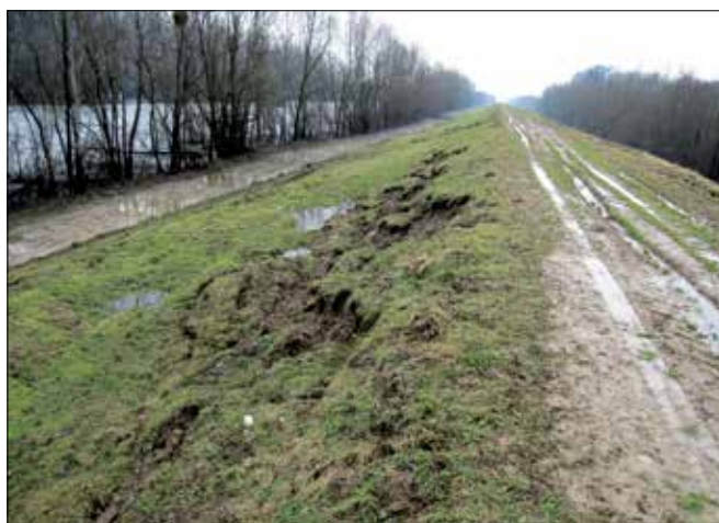
Fot. 1. Widok uszkodzonego obwałowania od strony wody oraz korony z widocznymi głębokimi koleinami
