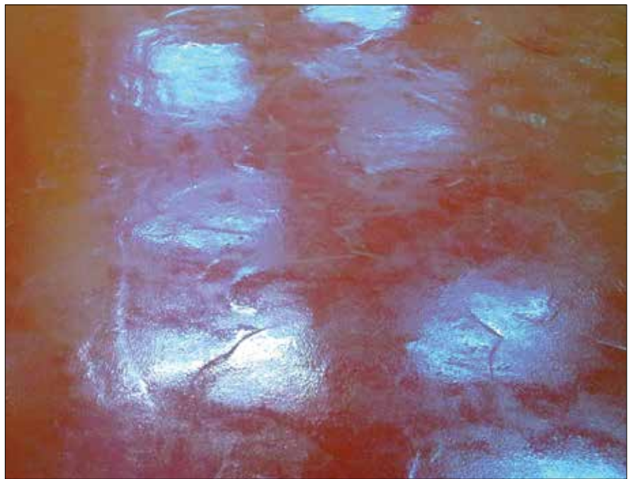
Fot. 12. Powłoka epoksydowa wykonana na niewyrównanym podłożu betonowym
