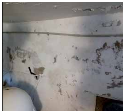
Fot. 3. Uszkodzenia ściany między tarasem naziemnym a naziemnym od strony pomieszczenia
