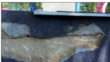
Fot. 2. Uszkodzenia ściany między tarasem naziemnym a naziemnym
