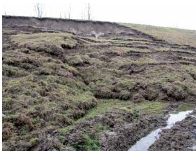
Fot. 2. Lokalne obsunięcie powierzchni wału
