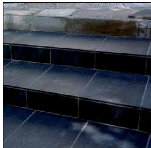
Fot. 4. Uszkodzenia schodów z tarasu naziemnego na taras naziemny
