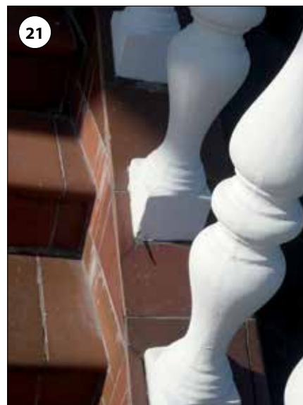
Fot. 19–21. Uszkodzenia stopni schodów pokazanych na fot. 17–18. Naprawa jest możliwa jedynie wtedy, gdy usunięte zostaną przyczyny uszkodzeń
