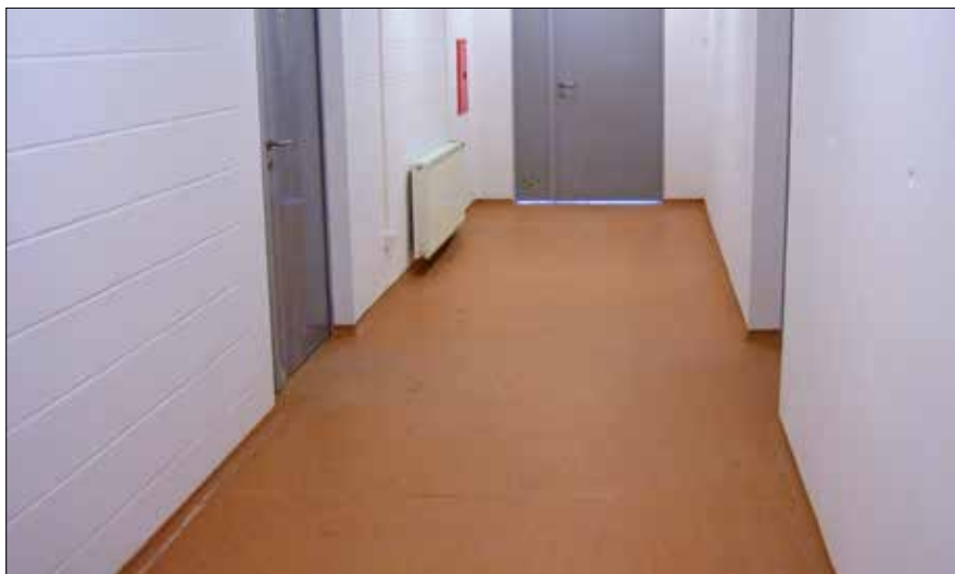
Fot. 5. Powłoka epoksydowa w pomieszczeniach technicznych
