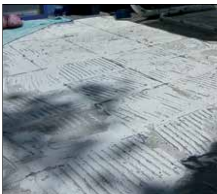
Fot. 1. Uszkodzenia na pości tarasu nad pomieszczeniem nieogrzewanym
