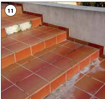
Fot. 10–12 Uszkodzenia stopni schodowych
