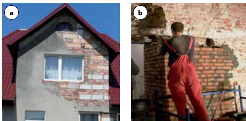
Fot. 1 | Brak kompatybilności nowego muru z pierwotnym podczas przemurowania
