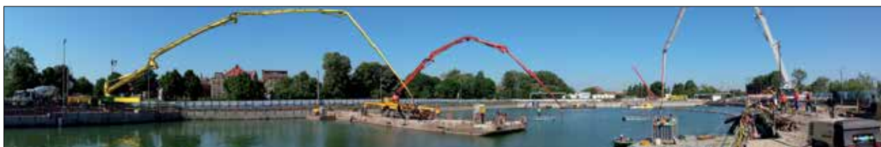
Fot. 10 | Widok na budowę – przepompowywanie betonu z pompy na brzegu do pompy na platformie pływającej
