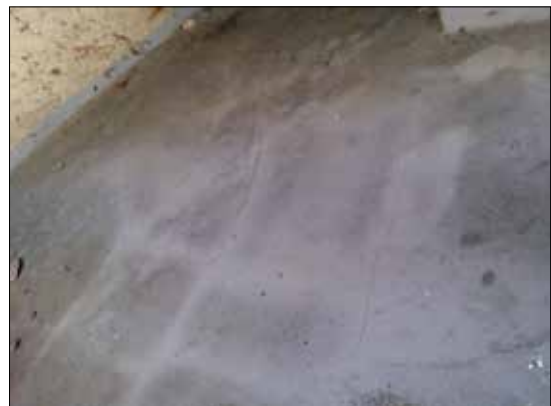
Fot. 4 | Pęknięcia zaprawy PCC na podporze mostu w środowisku miejskim
