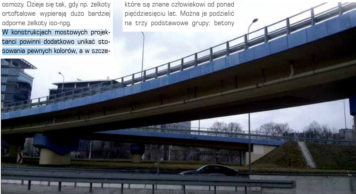
Fot. 3 | Gzysmy mostowe z betonu żywicznego po kilkuletniej ekspozycji na warunki atmosferyczne
