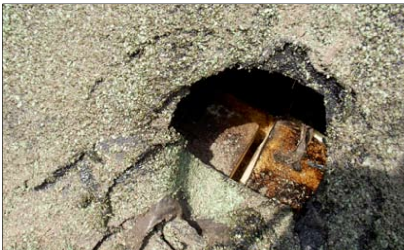
Fot. 2 | Dach spadzisty wykonany jako dach ocieplony. Papa termozgrzewalna ułożona na termoizolacji zsunęła się, powodując osunięcie dachu zielonego
