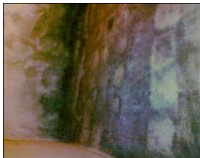
Fot. 2 | Grzyby pleśniowe w miejscach powstania mostków cieplnych i kondensacji pary wodnej
