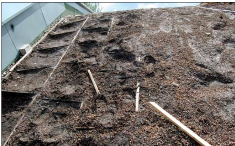
Fot. 5 | Konstrukcja zabezpieczająca wykonana z drewna uległa zniszczeniu już w trakcie realizacji dachu spadzistego, powodując osunięcie substratu
