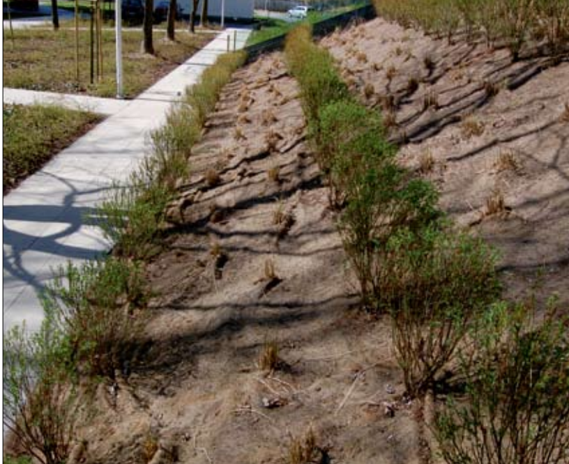
Fot. 6 | Mata antyerozyjna kokosowa nieprzymocowana do konstrukcji zapobiegającej poślizgowi stale zsuwa się nie zabezpieczając substratu
