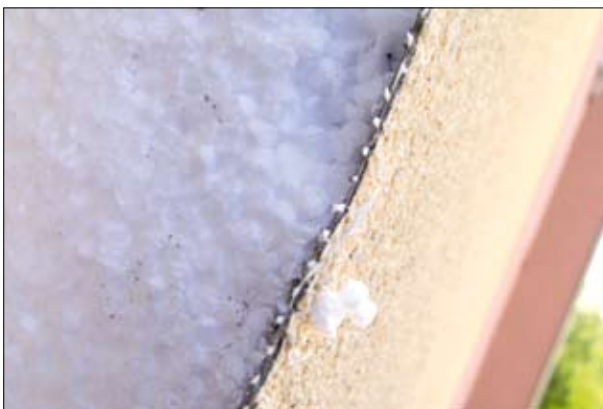
Fot. 3 | Siatka z włókna szklanego zatopiona w kleju o zbyt małej grubości
