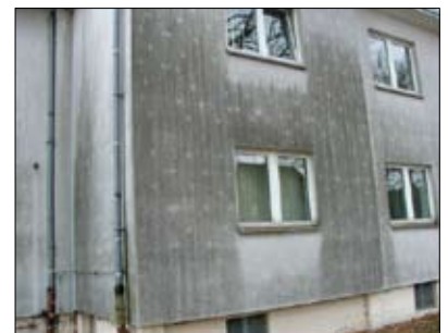
Fot. 1 | Elewacja zaatakowana przez glony
