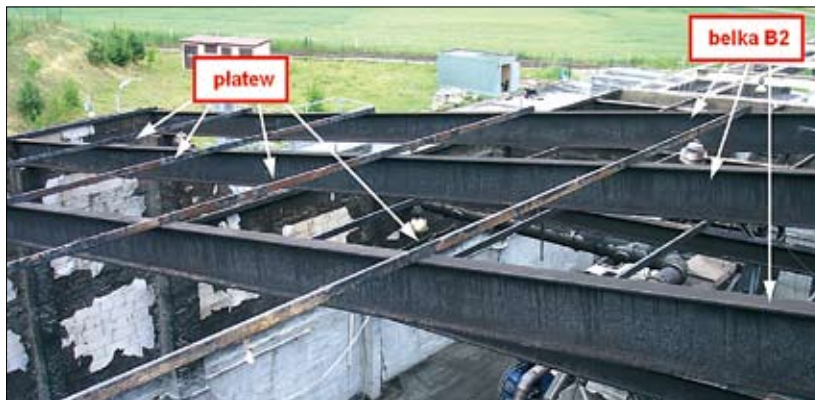
Fot. 4 | Główne dźwigary B2 i płatwie po pożarze
