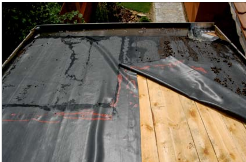
Fot. 1 | Nieprzyklejona membrana EPDM zsunęła się po deskach, tamując wypływ wody przez kątownik perforowany
