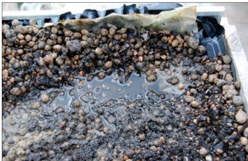
Fot. 3 | Warstwa drenażowa zsunięta się po hydroizolacji, pociągając za sobą substrat
