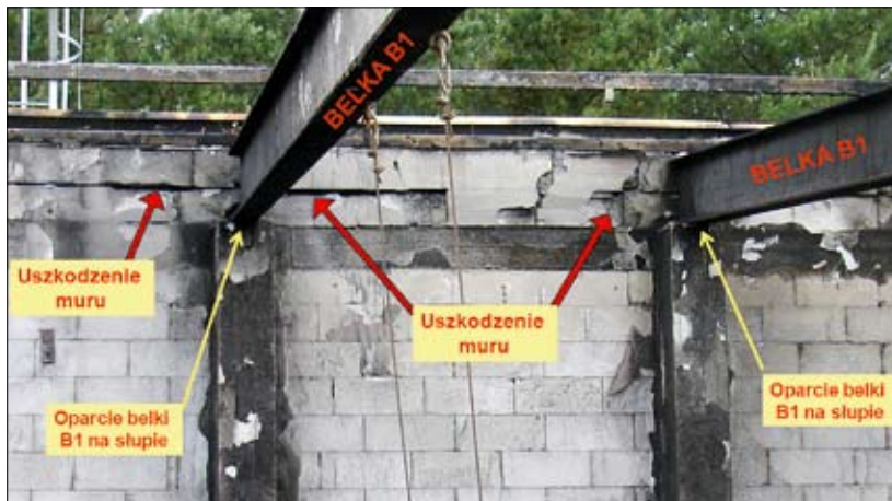
Fot. 5 | Uszkodzony mur ściany podłużnej hali produkcyjnej
