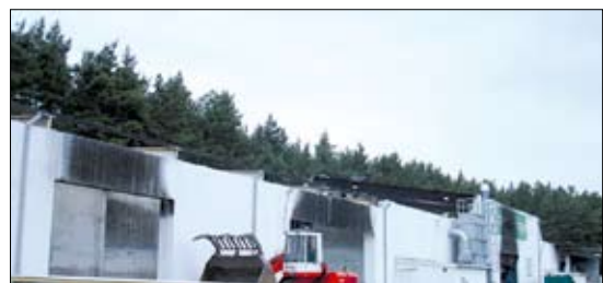
Fot. 1 | Hala po pożarze
