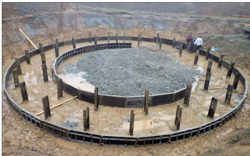
Fot. 2 Nowatorskie rozwiązanie posadowienia fundamentów turbin wiatrowych na kolumnach DSM zbrojonych profilami IPE, które wykonywała firma Keller
