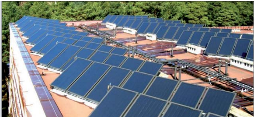
Fot. 3 | Widok kolektorów na dachu w ośrodku wypoczynkowym w Juracie (projekt instalacji opracował dr Jerzy Adamczyk współpracujący z firmą EKOpjekt)
