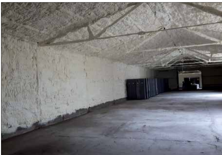
Fot. 4. Budynek magazynowy ocieplony od wewnątrz pianą PUR
