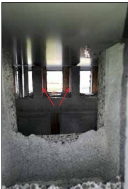
Fot. 6. Przesunięte ścianki wylotów bocznych
