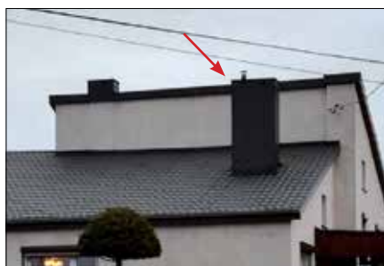
Fot. 3. Wyloty kominą usytuowane przy ścianie budynku
