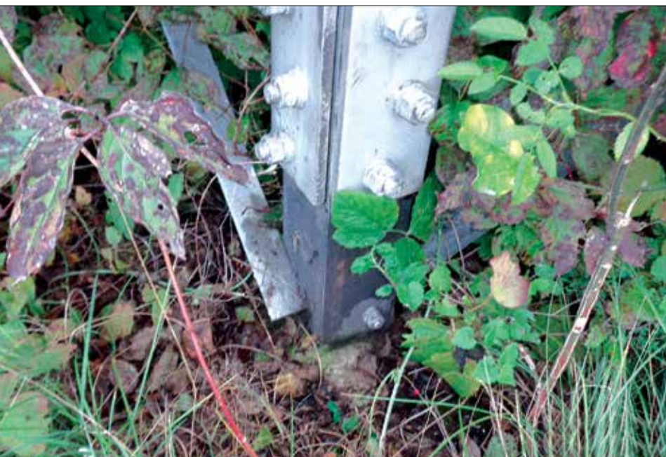
Fundament linii elektroenergetycznej SN pograżający się w gruncie, Vrelo, Chorwacja, 2018 r. (fot. K. Wirth)
