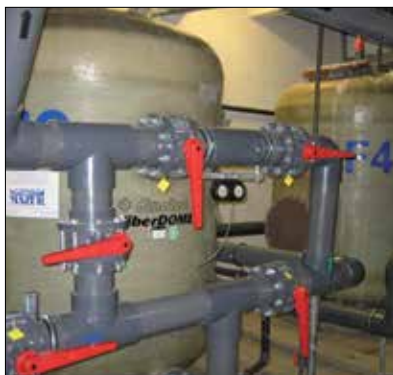
Fot. 5 | Przykład instalacji filtracji wody basenowej po remoncie
