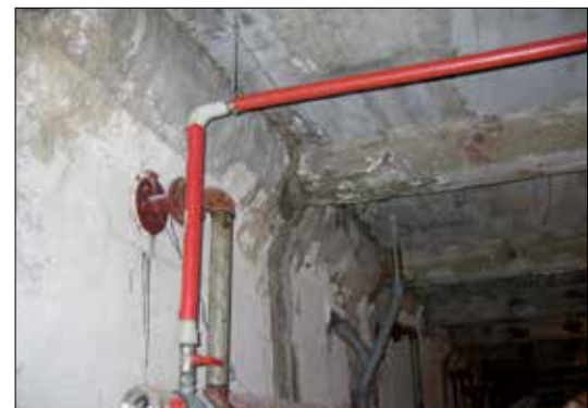
Fot. 7 | Instalacja cyrkulacji wody basenowej przed remontem
