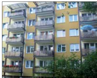
Fot. 6 | Mały balkon wspornikowy po 30 latach użytkowania, 4 lata po modernizacji (fot. autorka)
