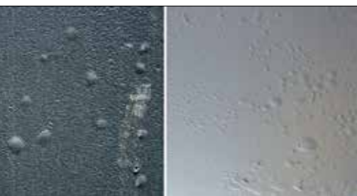
Fot. 2 | Przykłady występowania pęcherzy na powierzchni posadzki przemysłowej
