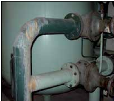
Fot. 4 | Przykład instalacji filtracji wody basenowej przed remontem
