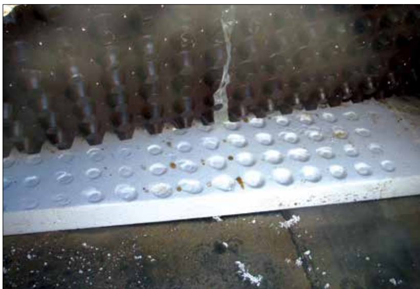
Fot. 7 | Termoizolacja uszkodzona przez drenaż
