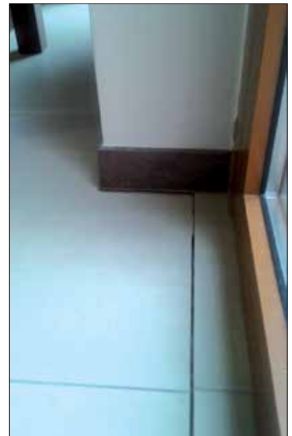
Fot. 4 | Takie uszkodzenie może być także skutkiem zastosowania zbyt miękkiej termoizolacji w warstwach podłogi (fot. autor)
