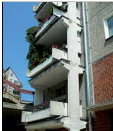
Fot. 7 | Budynek zrealizowany w systemie W-70. Widok dużych balkonów wolno stojących przed modernizacją (fot. autorka)
