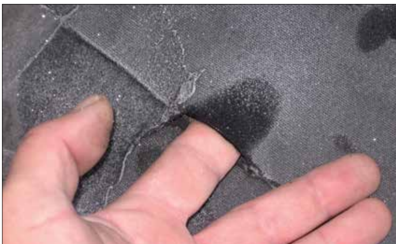
Fot. 2 | Rozszczeniony EPDM
