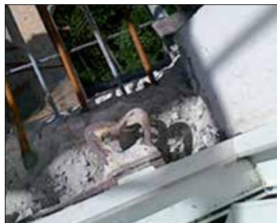
Fot. 5 | Widok zbrojenia małego balkonu wspornikowego po 30 latach użytkowania, 10 lat po remoncie (fot. autorka)
