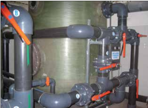
Fot. 12 | Zespół filtrów ciśnieniowych dla basenu po remoncie z galerią armatury
