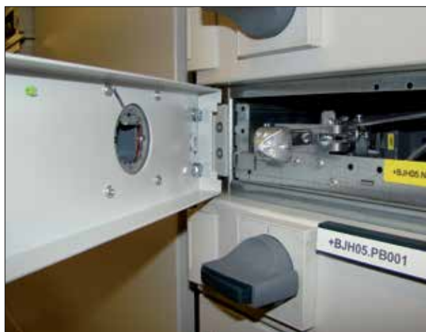
Fot. 2 | Zasada bezpieczeństwa: blokada drzwi przez napęd łącznika
