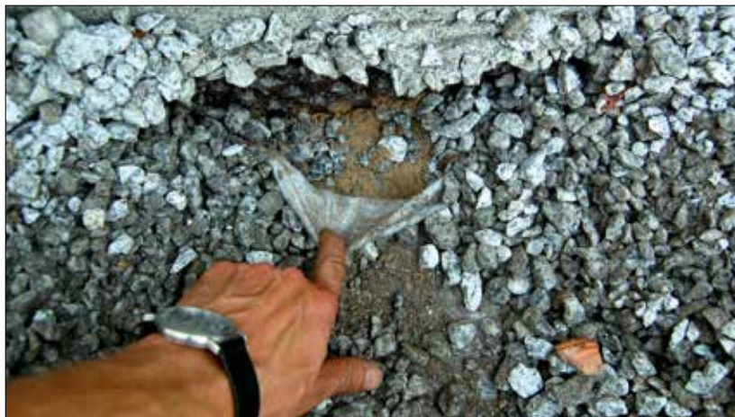
Fot. 8 | Nieprawidłowo wykonana opaska żwirowa
