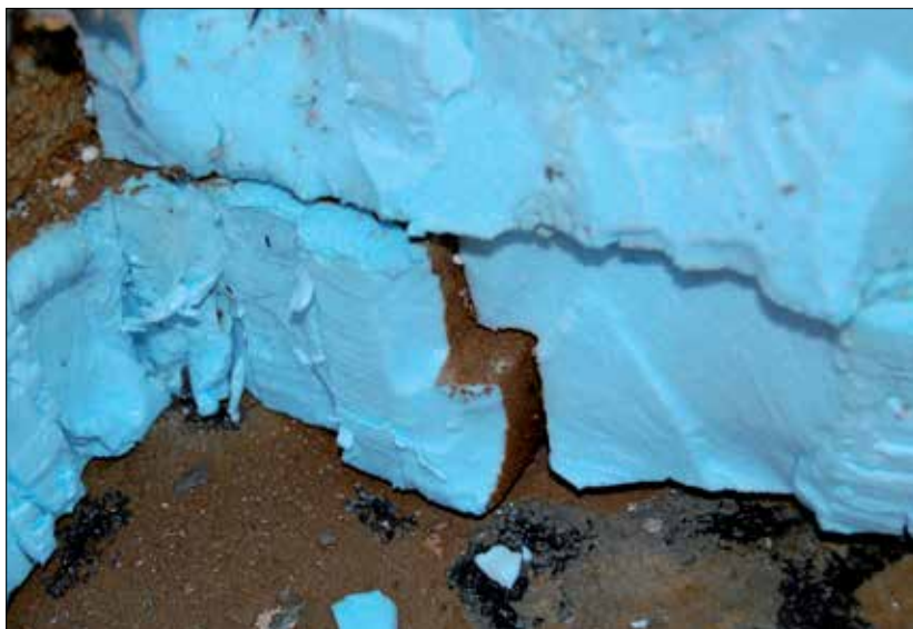
Fot. 6 | Płyty termoizolacji XPS z nieszczelnego tarasu
