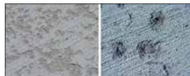
Fot. 3 | Przykłady występowania odprysków na powierzchni posadzki przemysłowej
