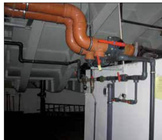
Fot. 11 | Zbiornik betonowy z instalacjami pod basenem o konstrukcji stalowej po remoncie
