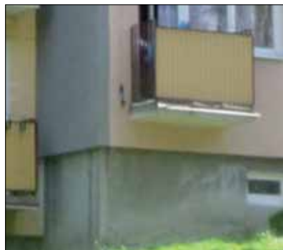
Fot. 4 | Mały balkon wspornikowy po 30 latach użytkowania, rok po remoncie (fot. autorka)
