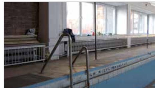
Fot. 1 | Niecka basenu przed remontem
