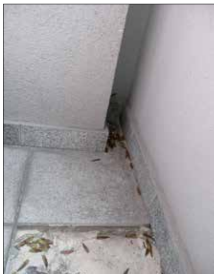
Fot. 10. Detal balkonu z balustradą pełną, ocieplenie z obu stron płyty i balustrady niesamowicie komplikuje nie tylko prace dociepleniowe, ale i hydroizolacyjne
