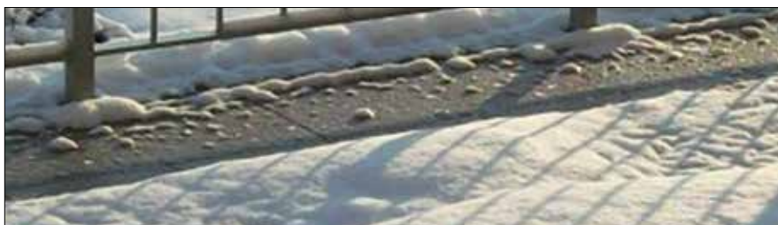
Fot. 12. Liniowy mostek termiczny na skutek błędu w remoncie tarasu; opis w tekście
