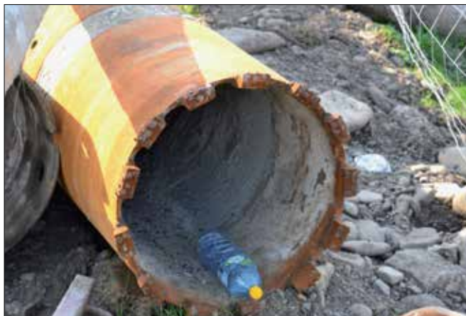
Fot. 3. Koronka wiertnicza na dole rury obsadowej umożliwiająca skrawanie betonu sąsiednich pali
