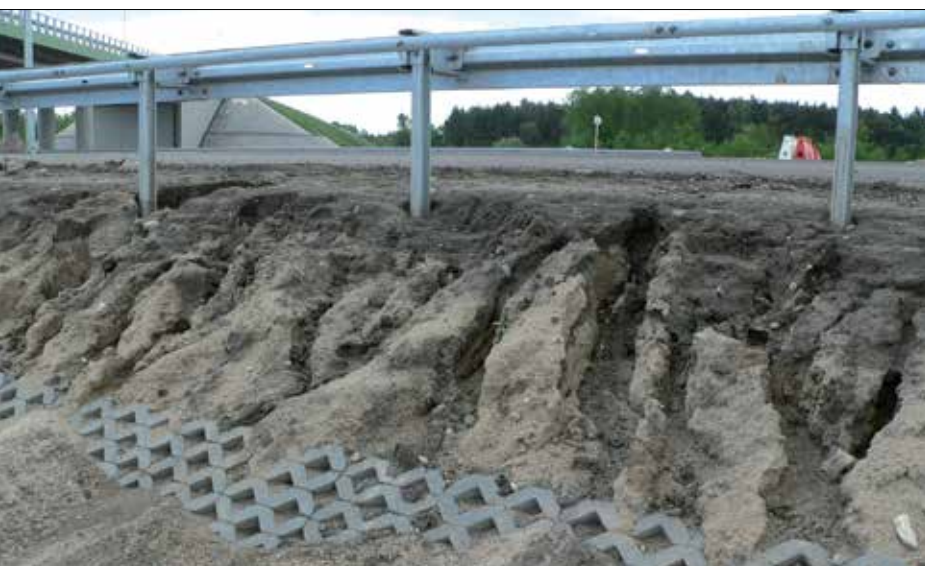
Fot. 1 | Na erozję narażone są nawet niewielkie skarpy
