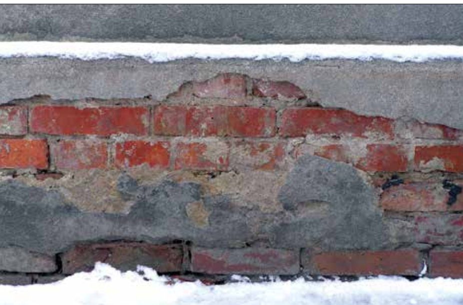
Fot. 2 | Zniszczenia tynku i cegły w obszarze przyziemia. Mimo zastosowania bardzo silnych i szczelnych wypraw cementowych odbita woda, śnieg i prawdopodobnie sole budowlane spowodowały całkowitą degradację tynku
