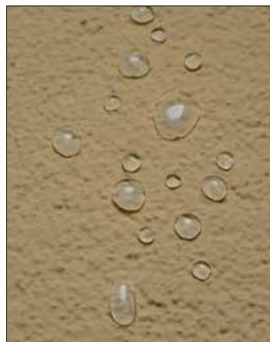
Fot. 7 | Charakterystyczny efekt hydrofobowy na farbie elewacyjnej. Wielkość kropli wody opadowej jest uzależniona od kąta napięcia powierzchniowego; im wyższy, tym kropla ma mniejszą powierzchnię styku z podłożem
