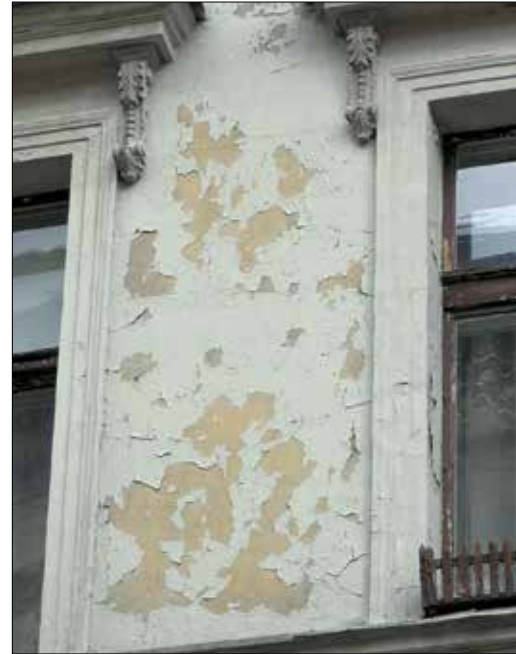
Fot. 5 | Charakterystyczne złuszczenia farby dyspersyjnej o zbyt niskiej dyfuzyjności
