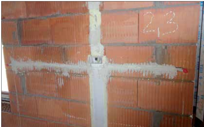
Fot. 3 | Nieuwzględniona w obliczeniach pozioma i pionowa bruzda w murze między oknami (fot. Ł. Drobiec)
