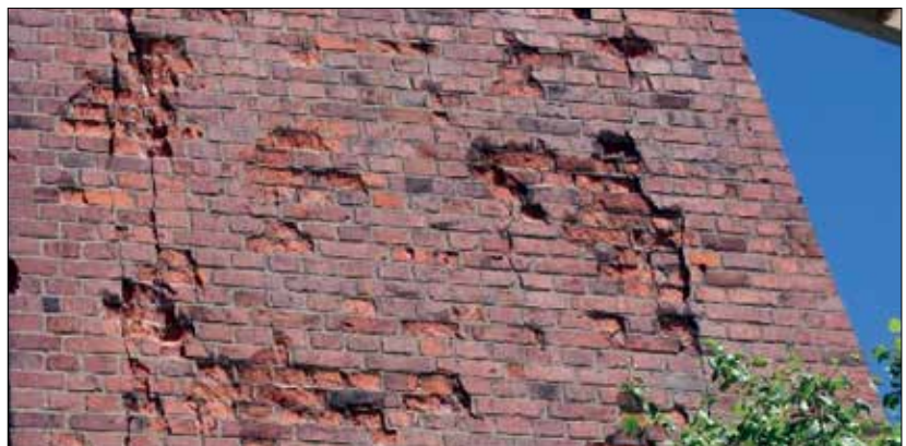
Fot. 4 | Fragment filaru, na którym oparto przęsło sklepienne i kratowe. Widoczne pęknięcia muru oraz powierzchniowe ubytki materiału
