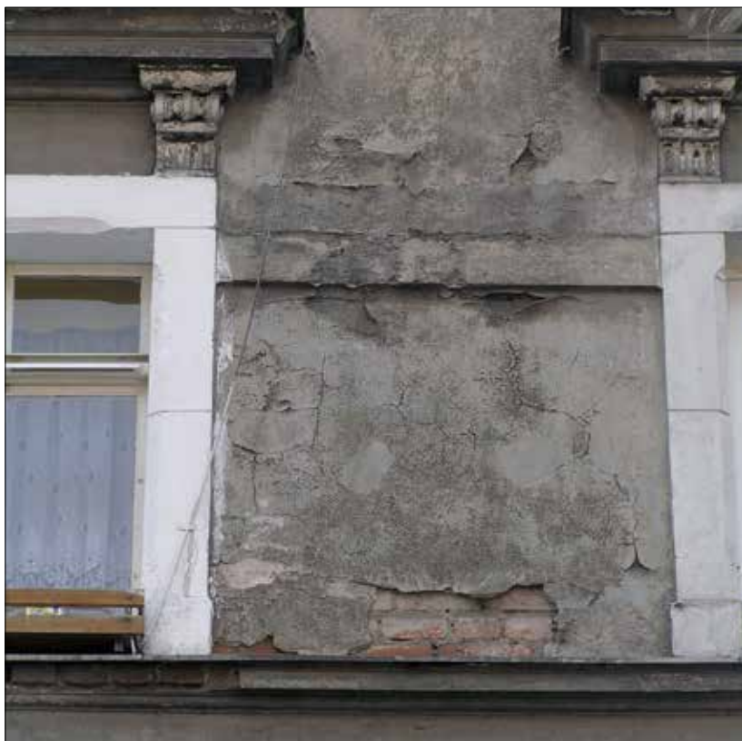
Fot. 1 | Zbyt silne zaprawy cementowe na zabytkowym podłożu, widoczne są już liczne spękania i odparzenia warstwy tynku
