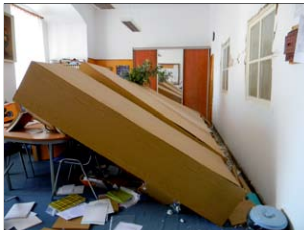
Fot. 3 | Fala uderzeniowa po wybuchu gazu w zachowanych częściach budynku powywracała sprzęt w pomieszczeniach szkoły na I i II piętrze
