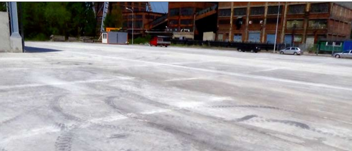
Plac na terenie Zakładu Recyklingu Metali Żelaznych i Kolorowych w Zabrze, realizacja 2014 r.
