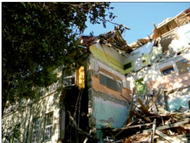
Fot. 2 | W wyniku fali uderzeniowej nadciśnienia spowodowanej wybuchem gazu na parterze – w bloku żywieniowym, w skrzydle wschodnim, zniszczeniu uległo ok. 25% całego obiektu; skrzydło wschodnie w dużej mierze przestało istnieć
