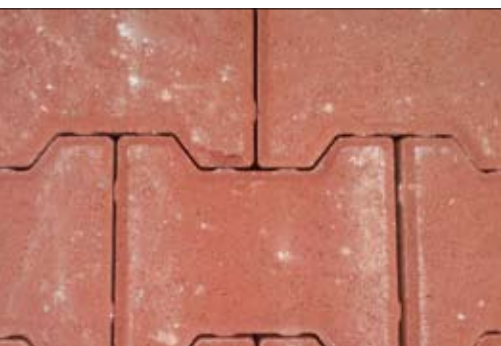
Fot. 2 | Strukturalne zniszczenie powierzchni betonowych bruków
