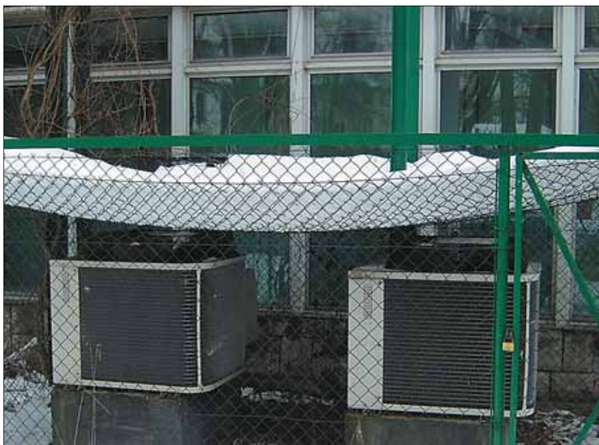
Fot. 1. Mokry śnieg zdeponowany i przymarznięty do ażurowej, siatkowej konstrukcji przekrycia, prowadzący do jego widocznego wyteżenia
