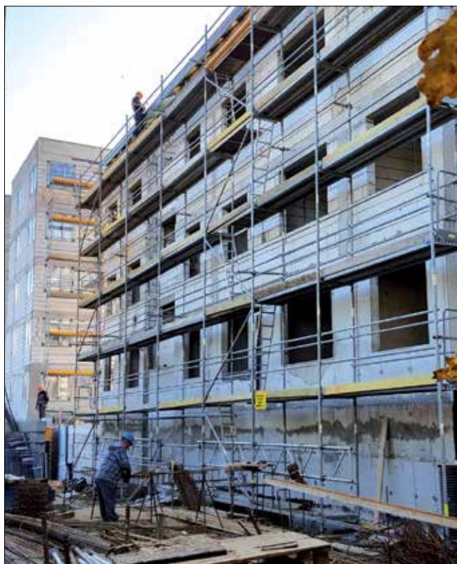
Fot. 1. Nie zachowano bezpiecznej odległości między rusztowaniem a stanowiskiem roboczym, brak wydzielenia strefy niebezpiecznej wokół rusztowania [9]
