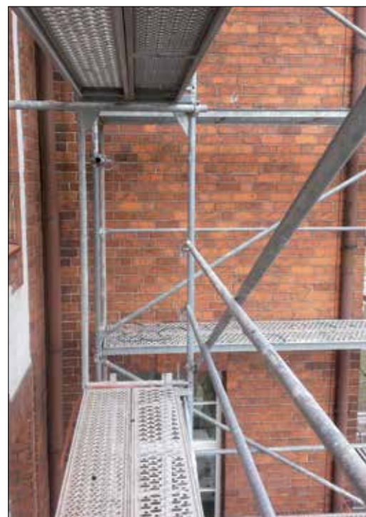
Fot. 7. Brak bariery szczytowej i wewnętrznej. Bariera zewnętrzna niekompletna – brak desek krawężnikowych [9]
