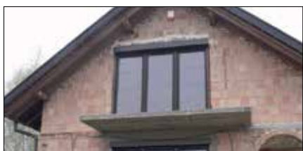
Fot. 9. Płyta balkonowa najczęściej wykonywana jest jako wspornikowa bez łącznika izotermicznego, co bardzo utrudnia poprawne wykonanie ocieplenia
