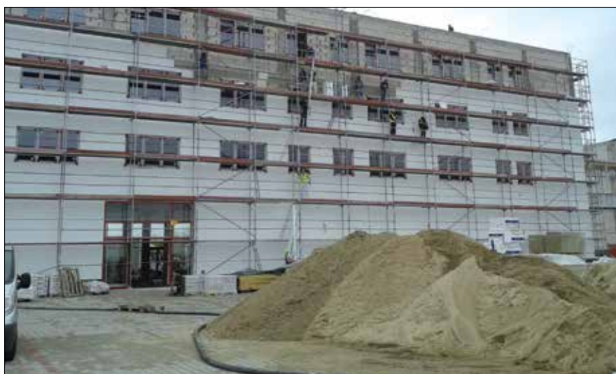
Fot. 3. Używane wejście do budynku w strefie rusztowania – niezabezpieczone daszkiem [9]
