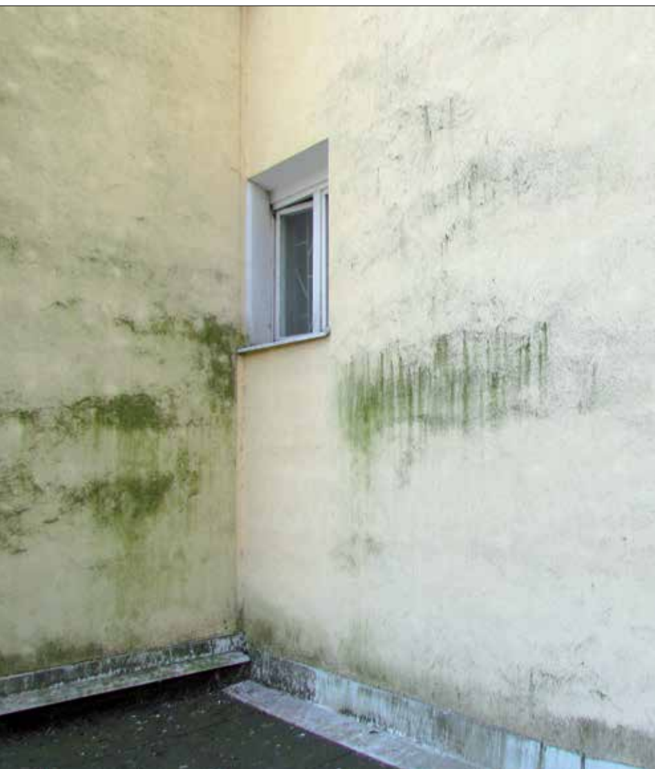
Fot. 5. Intensywny wzrost glonów w zacienionym, źle wentylowanym narożu budynku
