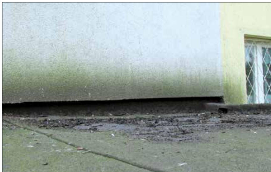
Fot. 4. Naloty glonów na daszku nad wejściem do klatki schodowej i na przyległej ścianie zawilgacanej wodą odpryskującą od daszku
