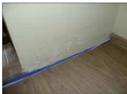
Fot. 4. Zawilgocenie ściany przy balkonie
