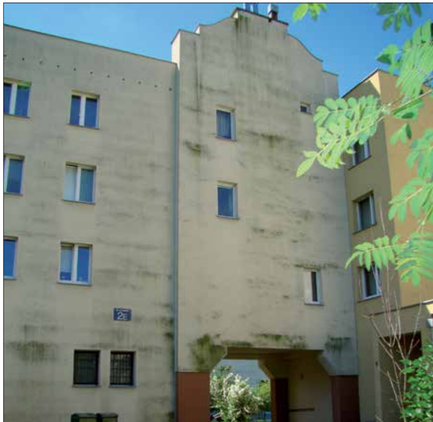
Fot. 2. Naloty glonów występujące w miejscach nierówności na styku płyt warstwy ocieplającej
