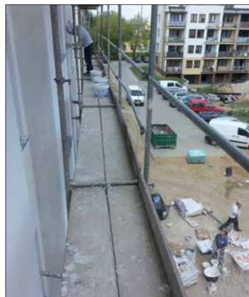
Fot. 8. Bariery wewnętrzne przewidziane na etapie montażu (tylko górna poręcz) – widać uchwyty i poręcz leżącą przy stanowisku pracownika; odległość od ściany wykończonej przekracza 30 cm [9]
