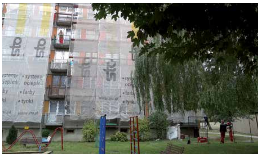
Fot. 2. Strefa niebezpieczna wokół rusztowania czy plac zabaw? [9]
