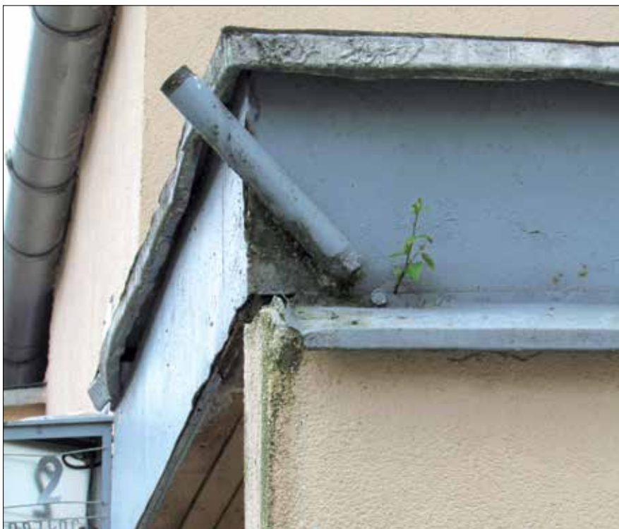
Fot. 3. Glony rosnące na ścianie zawilgoconej na skutek uszkodzonych obróbek blacharskich
