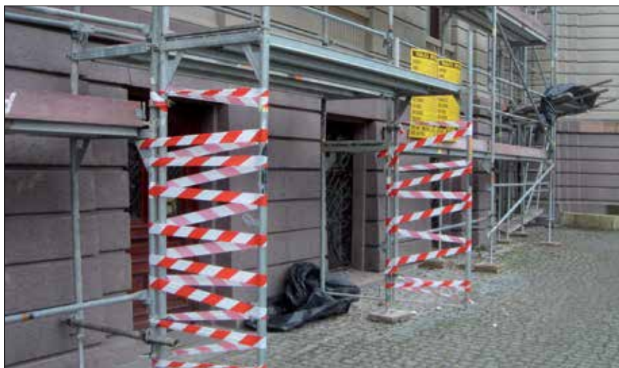
Fot. 4. Daszek ochronny o zbyt małym wysięgu, nieprawidłowe nachylenie [9]
