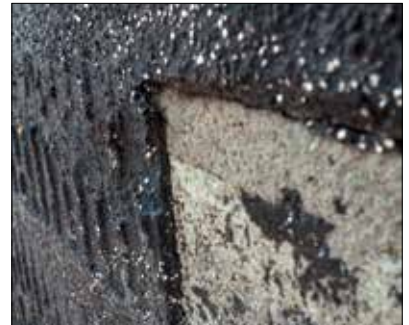
Ubytek wycięty z powłoki z masy bitumicznej
