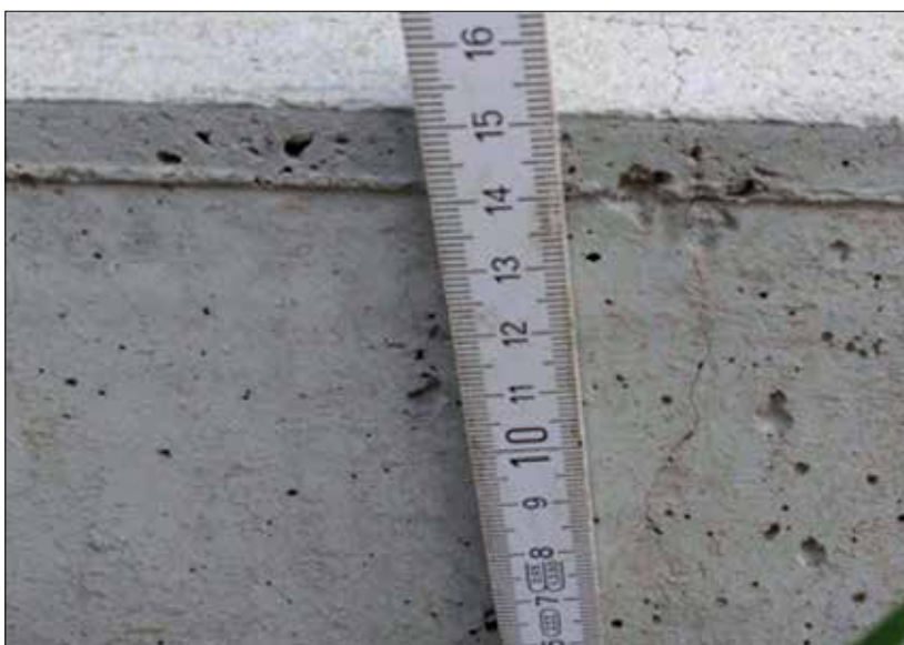
Fot. 4 | Zmierzona głębokość zarysowania – ok. 75 mm od górnej powierzchni
