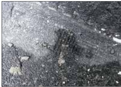
Fot. 10 | Widoczne oczka siatki świadczą o pocienieniu warstwy hydroizolacji (fot. autor)
