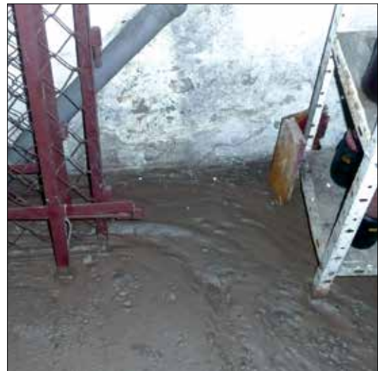
Fot. 18 | Podłoga w pomieszczeniu po opadach atmosferycznych przy przejściu rurowym „wykonanym po zaizolowaniu ściany” (fot. autor)
