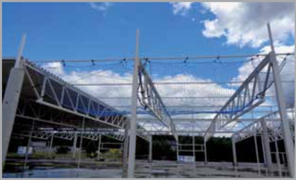
Siatki chroniące przed upadkiem podczas montażu poszycia dachu (fot. archiwum ERBUD S.A.)
