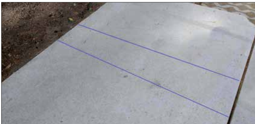
Fot. 3 | Ułożona płyta z dwiema rysami (przebieg rys zaznaczono niebieskimi liniami)
