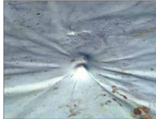
Fot. 19 | Potencjalne miejsce uszkodzenia hydroizolacji z folii z tworzywa sztucznego (fot. autor)
