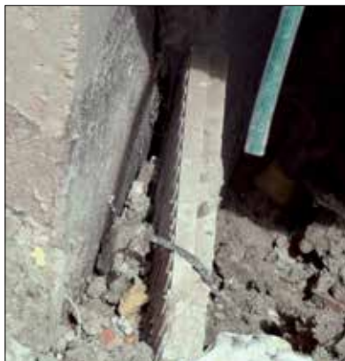
Fot. 12 | Uszkodzenia powłoki w narożnikach zewnętrznych. Widoczne także kuriozalne ułożenie „warstwy ochronnej” (fot. autor)
