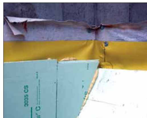
Fot. 21 | „Zamocowanie” płyt ochronnych, które zwykle skutkuje zerwaniem hydroizolacji (fot. autor)
