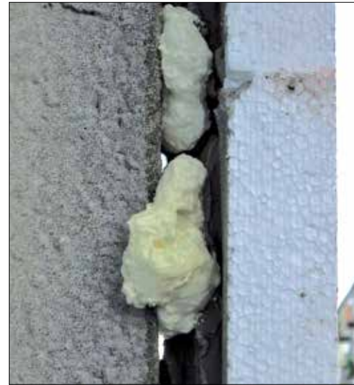
Fot. 1 | Przykład szkodliwej „pomysłowości” wykonawcy klejącego płyty izolacyjne. Próba połączenia wyrównania odchyłek podłoża z punktowo-krawędziową metodą nakładania kleju, wspomagana pianką montażową
