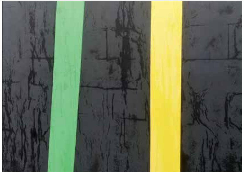
Fot. 2 | Obraz uwidocznionych wsiąkającą wilgocią rys powstałych na ociepleniu po ok. 12 latach eksploatacji. Powód: zły projekt (zbyt ciemna kolorystyka), zły materiał (zbyt miękki, kurczący się styropian), złe wykonawstwo (klejenie „na placki” i układanie warstwy zbrojonej „na dwa razy”)
