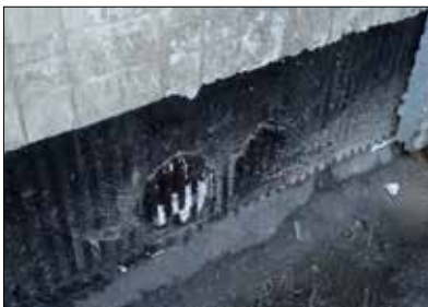
Fot. 9 | Uszkodzenia masy KMB na skutek niewykonania warstw ochronnych. W strefie styku z ławą fundamentową przyczyną uszkodzenia może być też złe ułożenie materiału termoizolacyjnego – przy takim ułożeniu wywiera on liniowy nacisk na hydroizolację (fot. autor)
