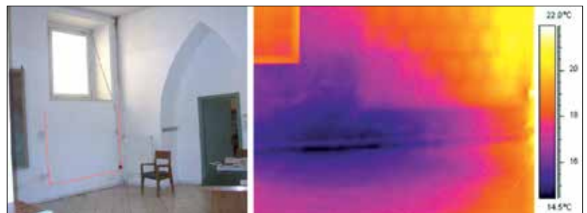
Rys. 7 | Fotografia oraz termogram wnętrza zażytkowego budynku szkoły uwidaczniający zamurowanie dawnego otworu drzwiowego oraz wyciek wody z instalacji centralnego ogrzewania; czerwoną linią oznaczono zarys zamurowanego otworu drzwiowego [4]
