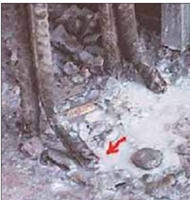
Fot. 1 | Błąd montażowy
