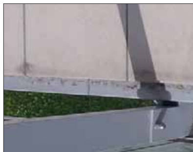
Fot. 2 | Korozja tradycyjnych obróbek blacharskich
