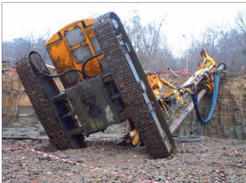
Fot. 2 | Awaria podczas prac geotechnicznych
