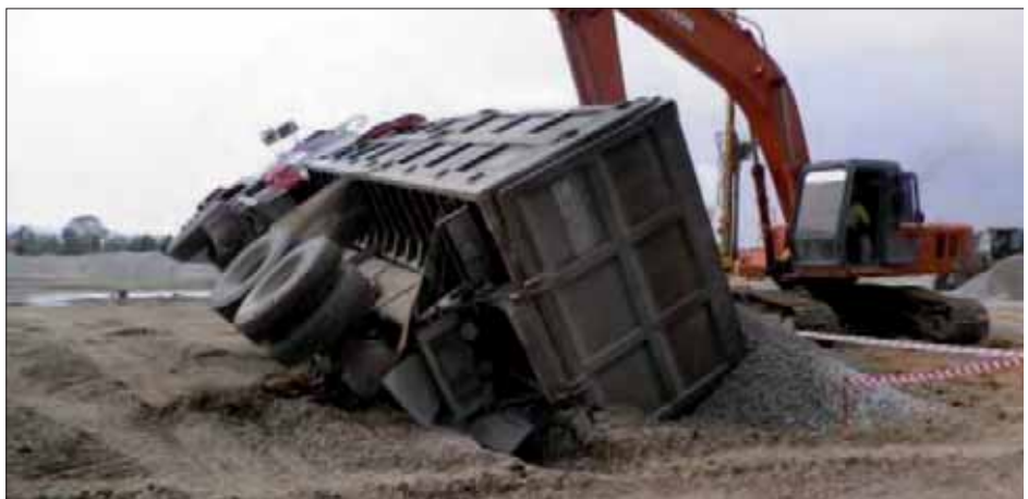
Fot. 1 | Awarie maszyn podczas prac geotechnicznych spowodowane brakiem odpowiedniej platformy roboczej
