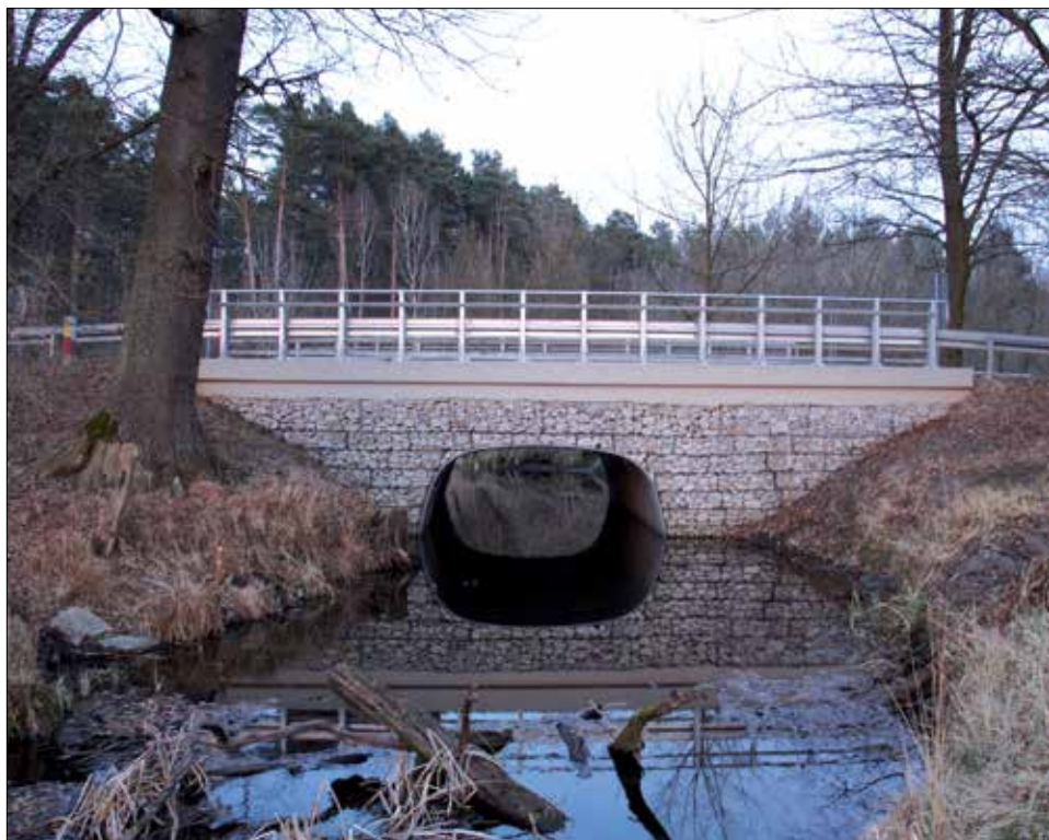
Fot. 1. Przykład renowacji obiektu drogowego z wykorzystaniem wzmocniającej konstrukcji ze stalowych blach falistych (fot. A. Wysokowski)
