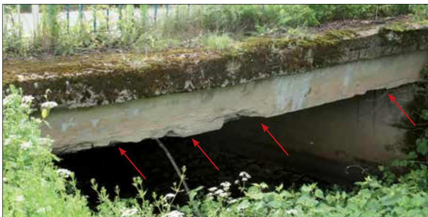
Fot. 2. Przykład uszkodzenia żelbetowego przepustu drogowego o konstrukcji płytowej (fot. A. Wysokowski)
