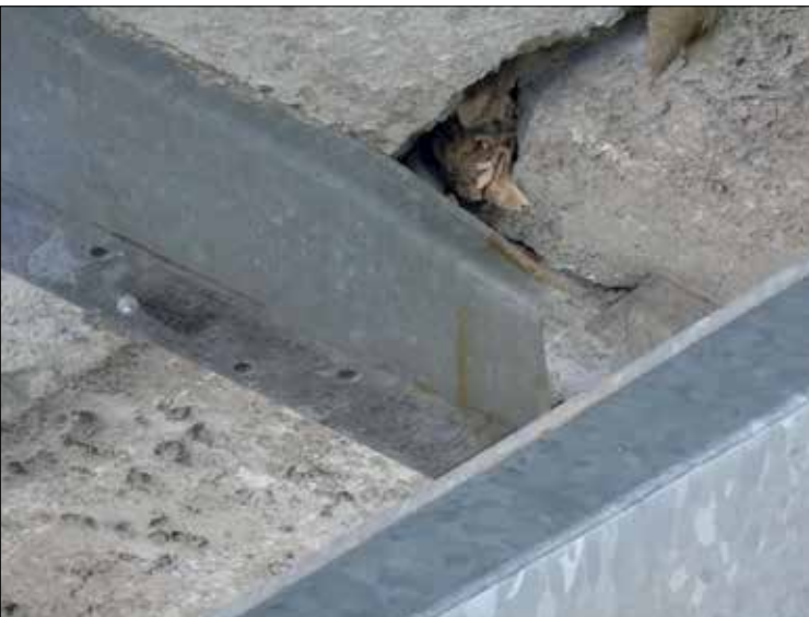
Fot. 2. Odształcona belka płyty stropowej stropu zespolonego stalowo-żelbetowego
