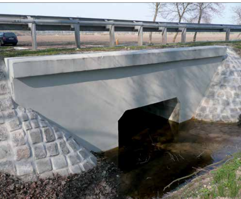
Fot. 7. Jeden z praktycznych przykładów wzmocnienia i renowacji przepustu drogowego (fot. A. Wysokowski)
