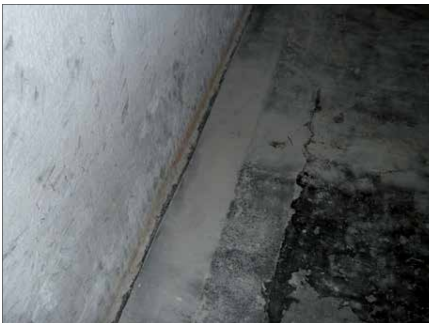
Fot. Wielokrotnie popełniany błąd – zbyt małe wysunięcie izolacji poziomej poza lico ściany. Jest to często bezpośrednia przyczyna przecieków, do tego trudna technicznie i kosztowna do naprawy (fot. autora)
