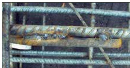
Fot. 2. Niewypełniona spoina łącząca pręty w zakładzie
