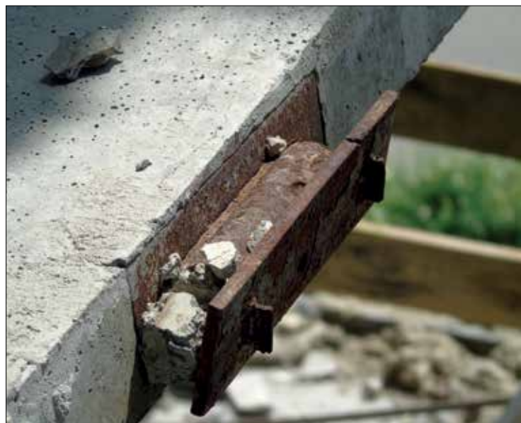
Fot. 5. Marka stalowa odkuta z płyty stropowej. Brak połączenia ze zbrojeniem płyty
