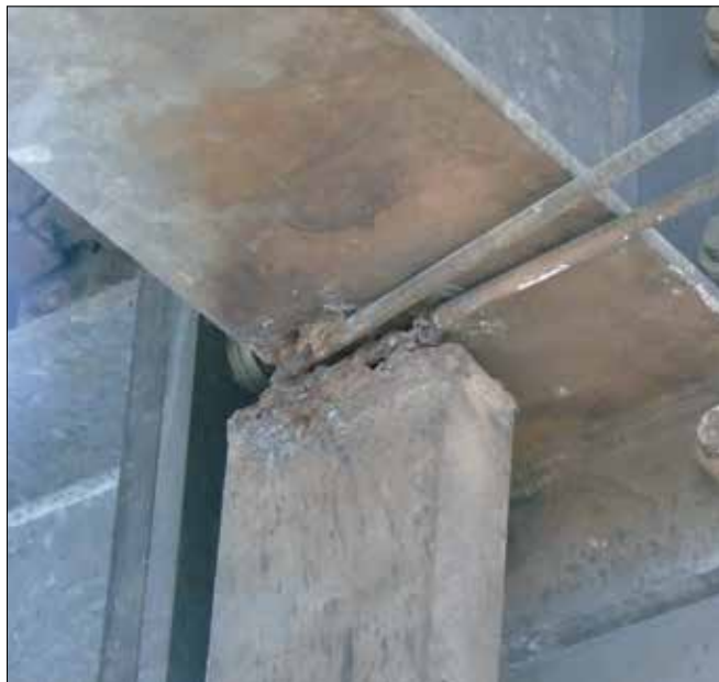
Fot. 7. „Coś” pozostawione podczas budowy po spawaniu stali ocynkowanej ogniowo
