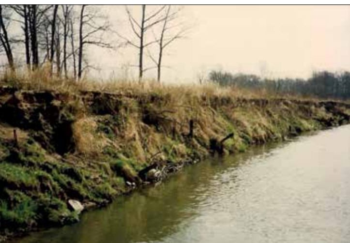
Fot. 1 i 2. Zerodowane brzegi rzeki
