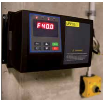
Fot. 2. Falownik do pompy obiegowej
