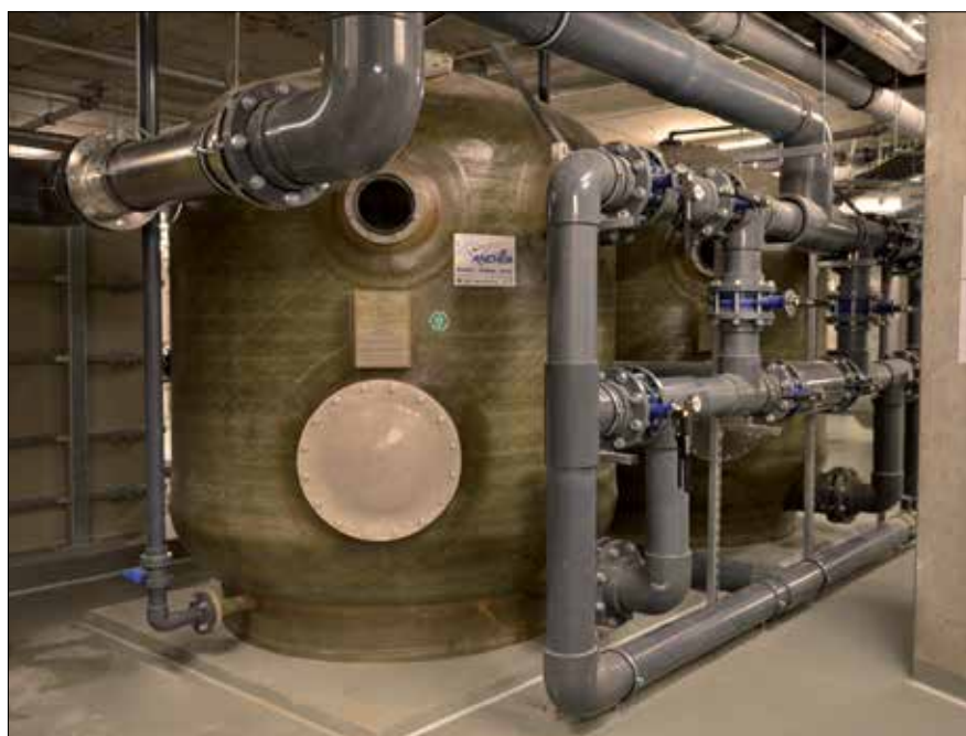
Fot. 4. Filtry basenowe
