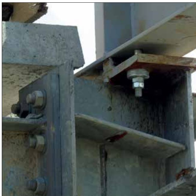
Fot. 9. Blachy węglowe oderwane od słupa. Widoczny brak spoin
