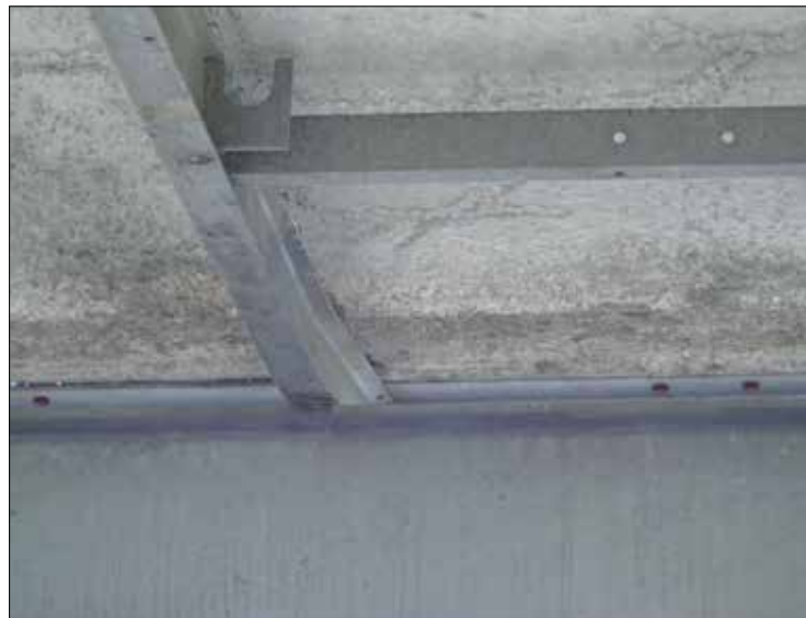
Fot. 3. Odształcenie strefy przypodporowej belek stalowych stropu zespolonego
