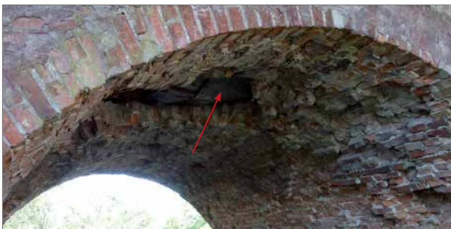
Fot. 3. Przykład uszkodzeń konstrukcji sklepienia przepustu ceglano (fot. A. Wysokowski)
