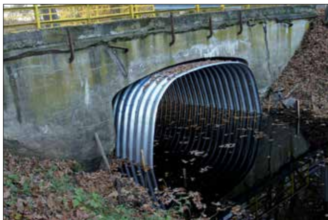
Fot. 4. Przykład stosowania materiałów w technologii reliningu – wzmacniająca konstrukcja ze stalowych blach falistych typu Boxculvert (fot. A. Wysokowski)
