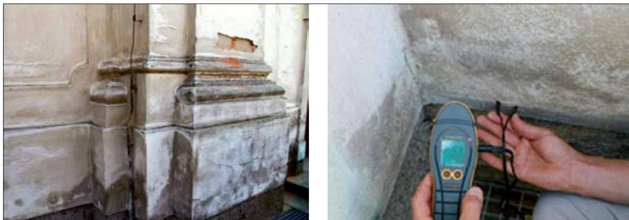
Fot. 2 | Przed rozpoczęciem prac należy określić stan zawilgocenia i zasolenia murów
