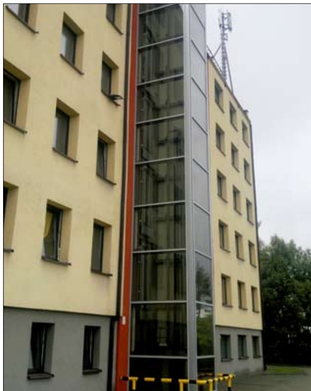
Fot. 3 | Pięciopiętrowy budynek w Cieszyźnie z dobudowanym dźwigiem zewnętrznym (fot. archiwum GMV Polska)
