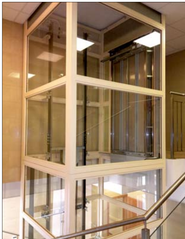
Fot. 4 | Dźwig dobudowany we wnętrzu budynku w Warszawie (fot. archiwum GMV Polska)
