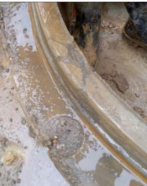
Fot. 10 | Nieumiejętna naprawa uszkodzonego górnego złącza dennicy
