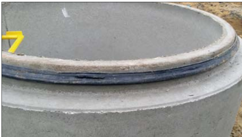
Fot. 8 | Zniszczenie klinowej uszczelki
