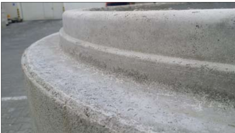
Fot. 7 | Jakość powierzchni betonowego złącza (mieszanka betonowa o konsystencji wilgotnej) po zdjęciu stalowego pierścienia
