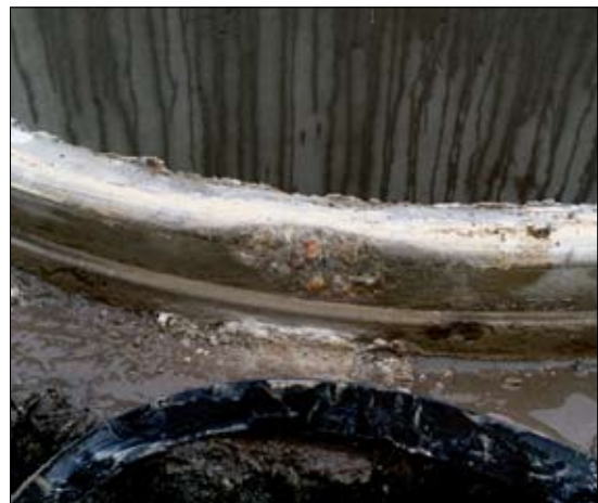
Fot. 11 | Uszkodzenie górnego złącza kręgu
