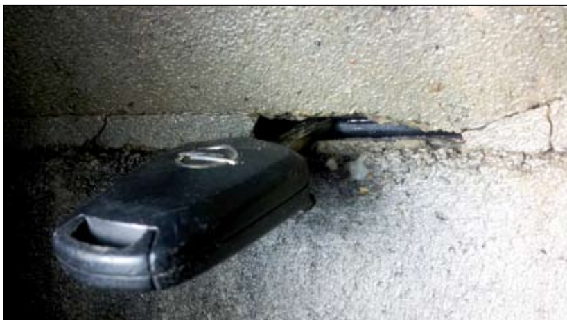
Fot. 9 | Źle zamontowana uszczelka samoślizgowa
