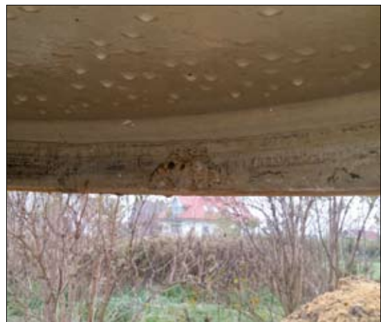
Fot. 12 | Uszkodzenie dolnego złącza płyty pokrywowej
