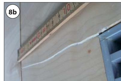
Fot. 8 | Spękanie płyty drewnianej obudowy
