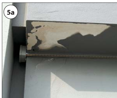
Fot. 5 | Braki w elewacji
