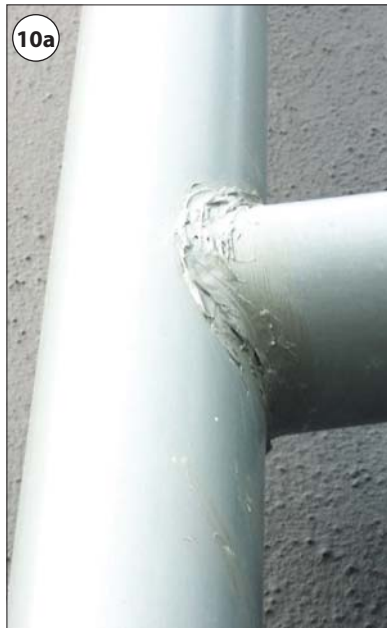
Fot. 10 | Klejony styk rur spustowych
