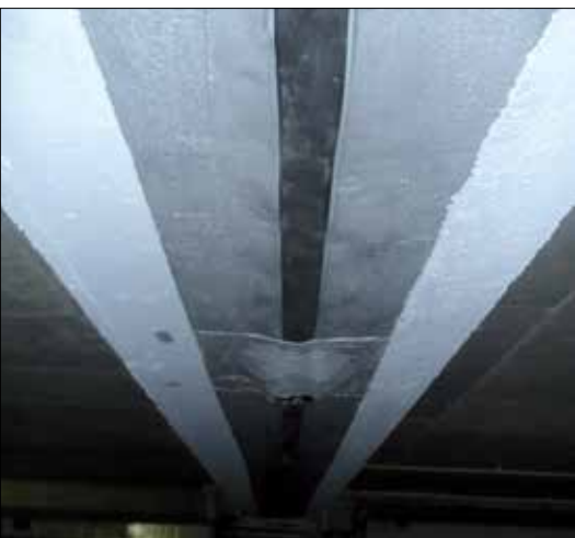
Fot. 1 | Dylatacja konstrukcyjna stropodachu garażu podziemnego pomiędzy sprężonymi belkami nośnymi uszczelniona od wewnątrz. Ewidenty błąd wykonawczy (fot. autora)
