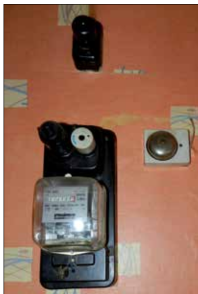
Fot. 1 | Tablica licznikowa z bezpiecznikami w mieszkaniu (fot. autora)
