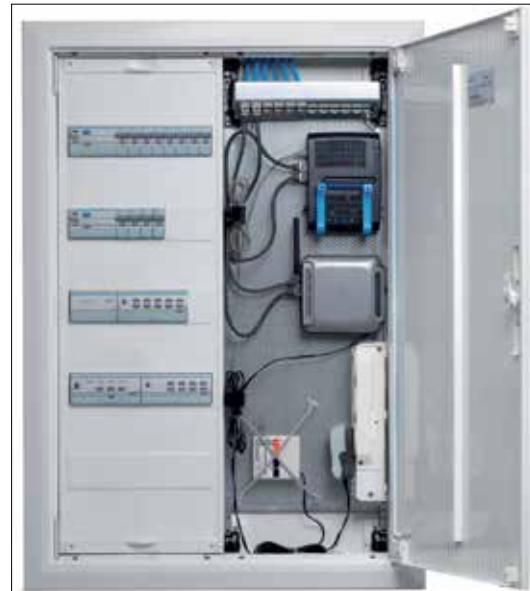
Fot. 4 | Tablica mieszkaniowa i skrzynka telekomunikacyjna we wspólnej obudowie serii VOLTA (fot. Hager)
