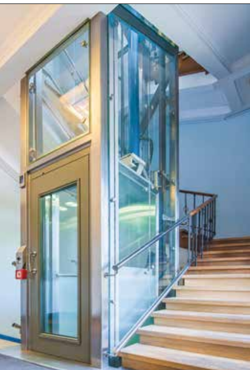
Fot. 1 Dźwig cichobieźny wraz z panoramicznym szybem o konstrukcji ze stali nierdzewnej zainstalowany w Pałacu Kultury i Nauki w Warszawie (fot. autora)
