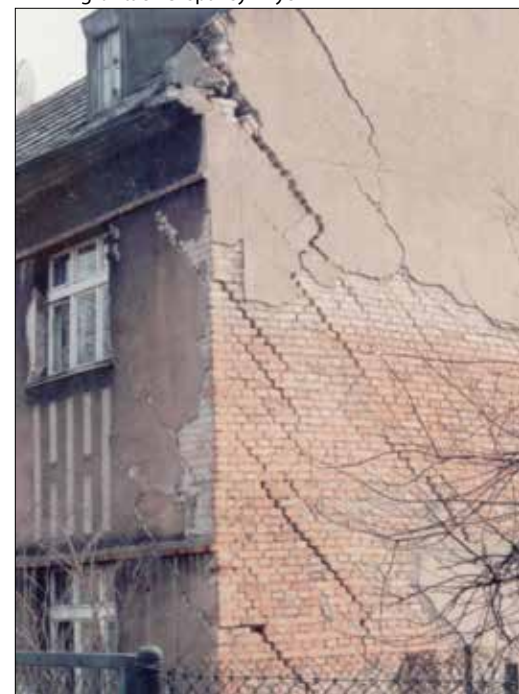
Fot. 1 | Typowe uszkodzenia budynku na gruntach ekspansywnych
