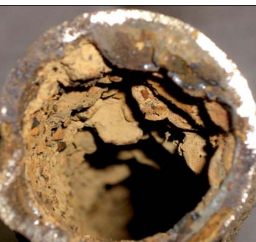
Fot. 5 | Inkrustacja – przewod przyłącza wodociągowego
