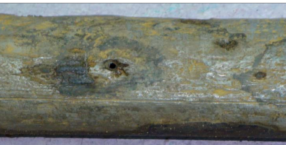
Fot. 6 | Awaria na rurze przyłącza wody – perforacja ocynkowanej stalowej rury
