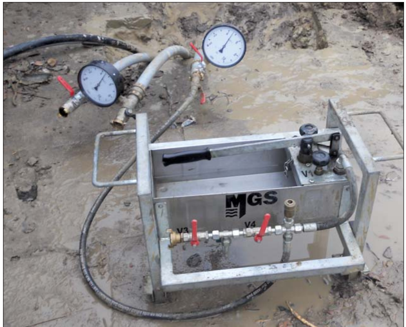
Fot. 3 | Próba szczelności instalacji sondy pionowej za pomocą pompki Rottenberga (fot. archiwum Mostmarpal)
