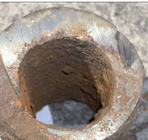
Fot. 4 | Rury żelwne na podłączeniu wodociągowym z 1935 r.
