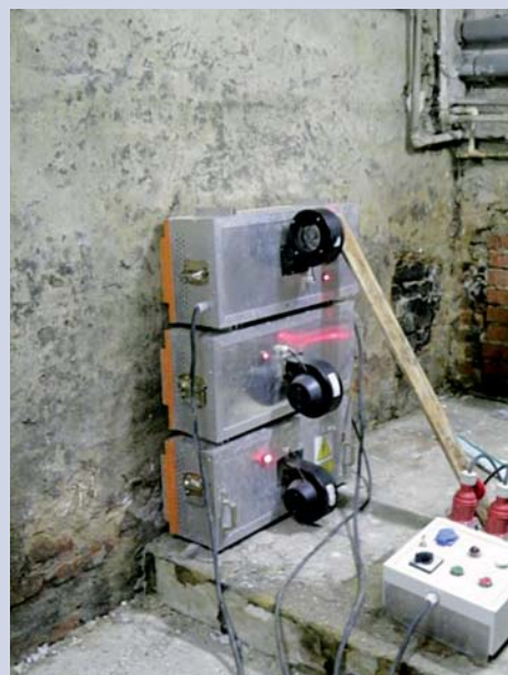
Rys. 10. Widok generatorów mikrofalowych osuszających mur.
